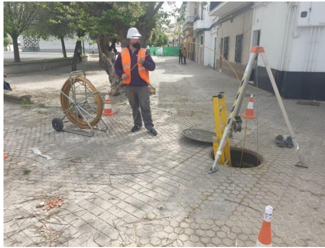
Fotografía 22: Operario desenrolla la guía acero mientras su compañero dentro de la cámara la introduce por el conducto para trabajos de mandrilado en la ronda del Tamarguillo (Sevilla). Fuente: foto del autor.
