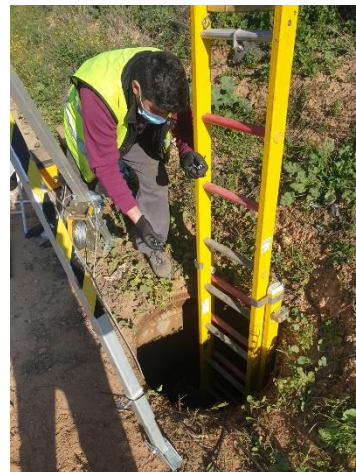
Fotografía 37: Operario pasándole, desde fuera de una cámara de registro de telecomunicaciones, tornillos y grapas a su compañero en el interior de la cámara en Sanlúcar la Mayor debido a encontrarse inundada y acceder con vadeadora con riesgo de darle al compañero. Fuente: foto del autor.
