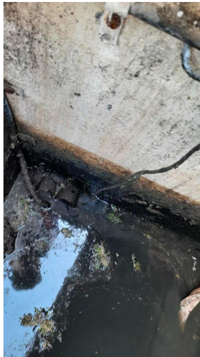
Fotografía 45: fondo de arqueta sometida a un alto grado de humedad en Castilleja de la Cuesta que presenta un aspecto en el que la presencia de microorganismos es muy probable. Fuente: foto del autor.
