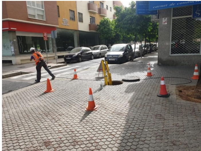
Fotografía 50: Operario tirando del cable que sale de una cámara de registro en la localidad de Sevilla (ronda del Tamarguillo), atravesando una calzada con el cable exponiéndose a riesgo de atropello. Fuente: foto del autor.
