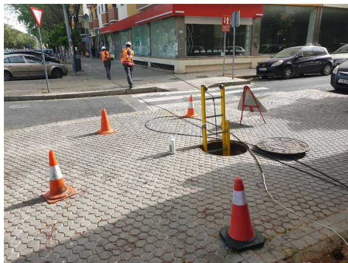
Fotografía 44: Operarios tirando del cable que sale de una cámara de registro en la localidad de Sevilla, en la ronda del Tamarguillo, generando riesgo de caída en altura para los peatones al dejar la cámara descuidada con un balizamiento deficiente. Fuente: foto del autor.
