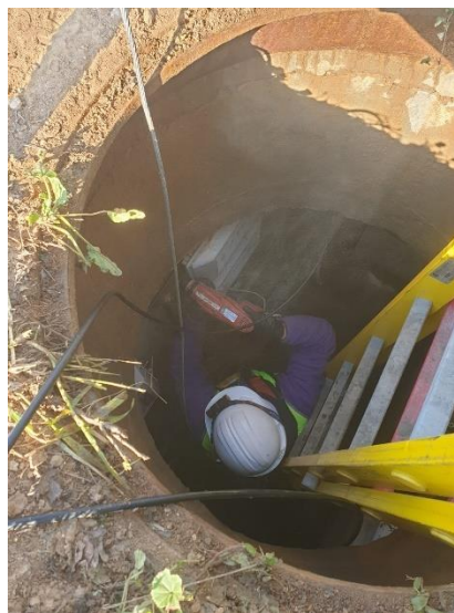
Fotografía 38: Operario en riesgo de sufrir proyecciones de partículas en los ojos al realizar labores de instalación de equipos de telecomunicaciones en el interior de una cámara de registro en Sanlúcar la Mayor haciendo uso de un taladro portátil. Fuente: foto del autor.
