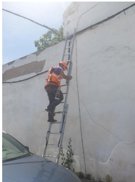
Fotografía 08: Operario realizando labores de tendido de fibra óptica por fachada en paralelo a los cables eléctricos con una escalera de aluminio expuesto al riesgo eléctrico en el barrio sevillano de San Jerónimo. Fuente: foto del autor.
