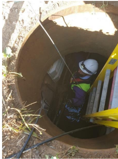
Fotografía 39: Operario realizando labores de instalación de equipos de telecomunicaciones en el interior de una cámara de registro en Sanlúcar la Mayor que se encuentra inundada expuesto a un alto grado de humedad. Fuente: foto del autor.
