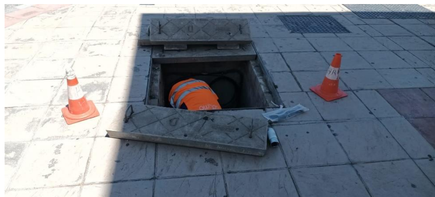
Fotografía 51: Trabajador haciendo labores de despliegue de cable de telecomunicaciones en una arqueta en el Parque Comercial Alavera de San Juan de Aznalfarache con riesgo de anoxia. Fuente: foto del autor.
