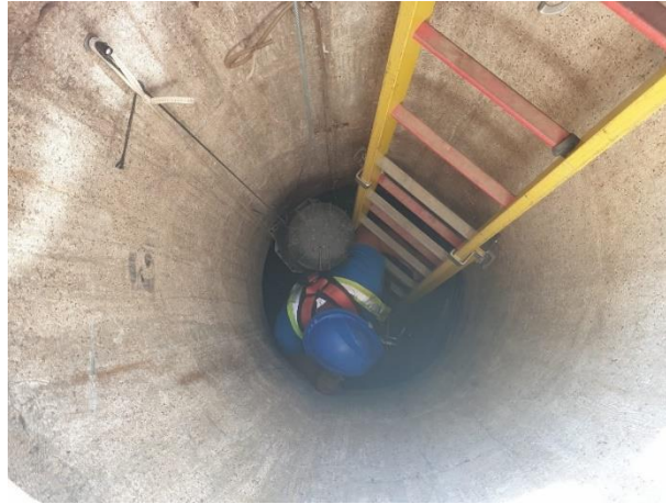
Fotografía 42: Operario accediendo a una cámara de registro en Tomares con el cuello de longitud considerable entorpecido por una caja de empalme suspendida de una cuerda fijada a un clavo. Fuente: foto del autor.
