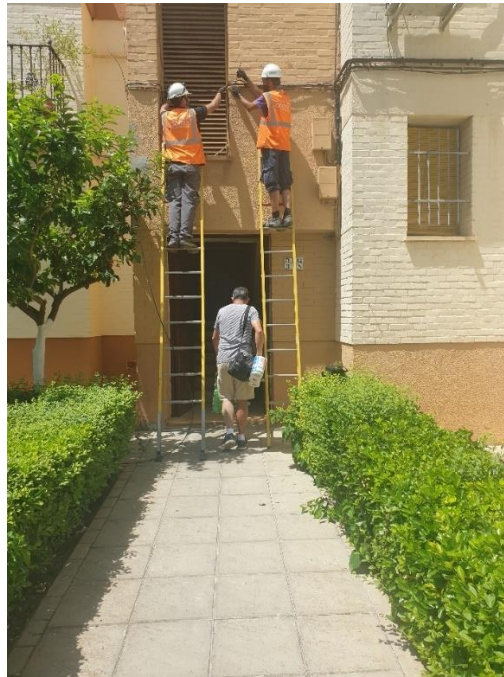
Fotografía 01: Operarios desplegando el cableado por fachada en Brenes a la altura de una puerta de bloque por donde acceden los peatones poniendo en riesgo la seguridad de los trabajadores al poder caer de las escaleras y la suya propia al existir el riesgo de caída de objetos. Fuente: foto del autor.
