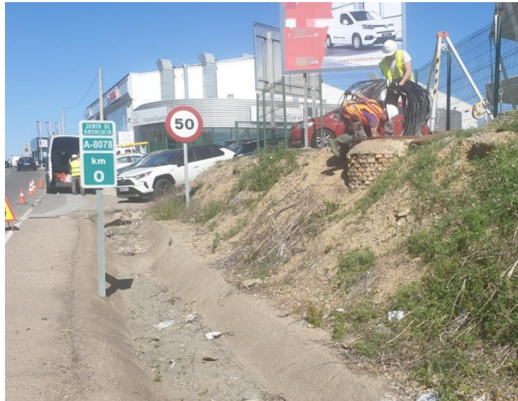
Fotografía 43: Operarios manipulando balona de cable para guardarlo dentro de una cámara de registro en el polígono Los Girasoles (Camas) con riesgo de caída en altura tanto hacia dentro de la cámara como hacia fuera debido al terraplén.
