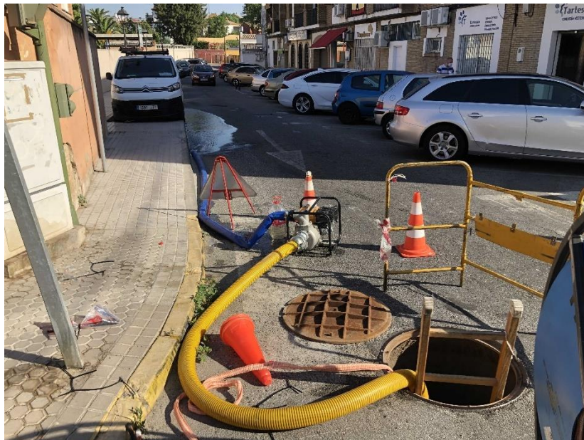
Fotografía 21: Desagüado de una cámara de registro de aguas pluviales y vertido a la vía pública buscando la red pública de desagüe. Fuente: foto del autor.
