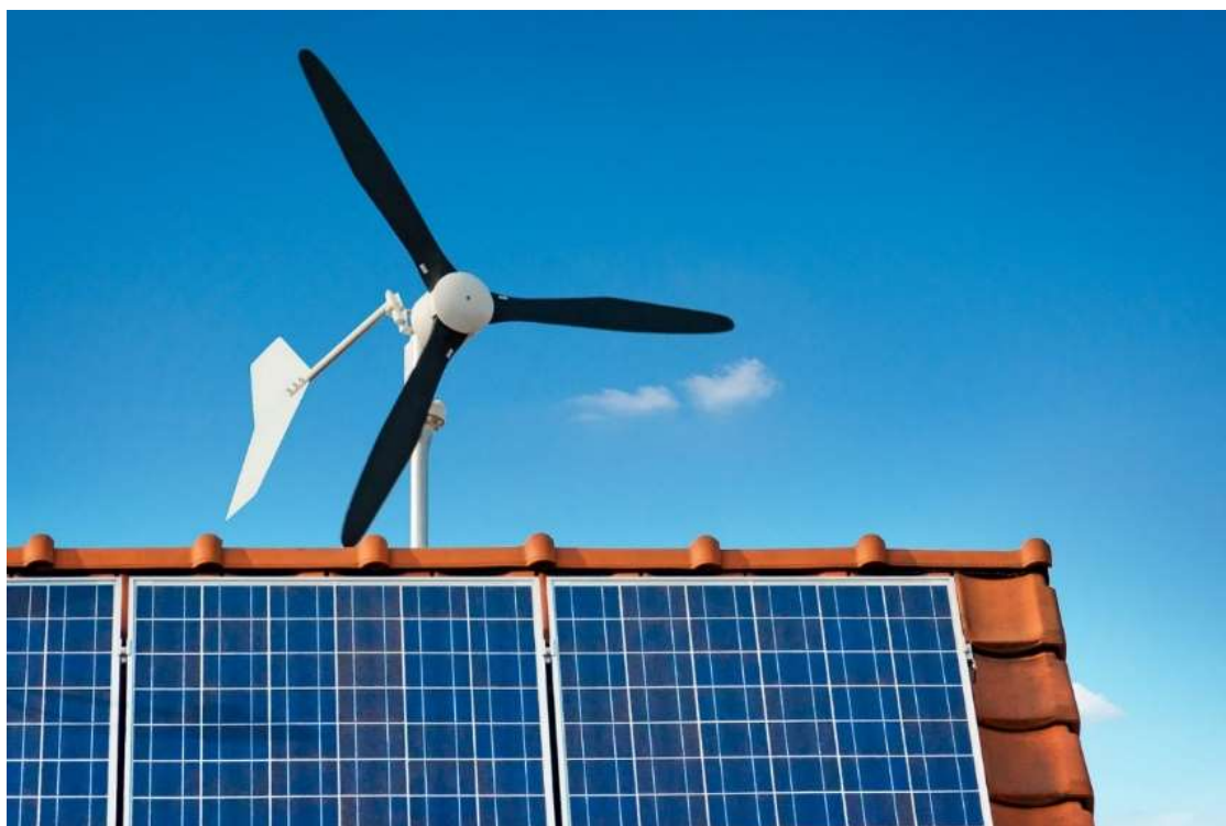
Figura 21. Instalación combinada de fotovoltaica y minieólica
