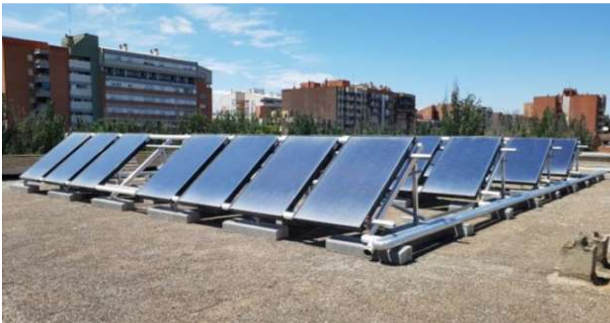
Figura 15. Instalación solar híbrida en el parque de bomberos 1 de Zaragoza, España
