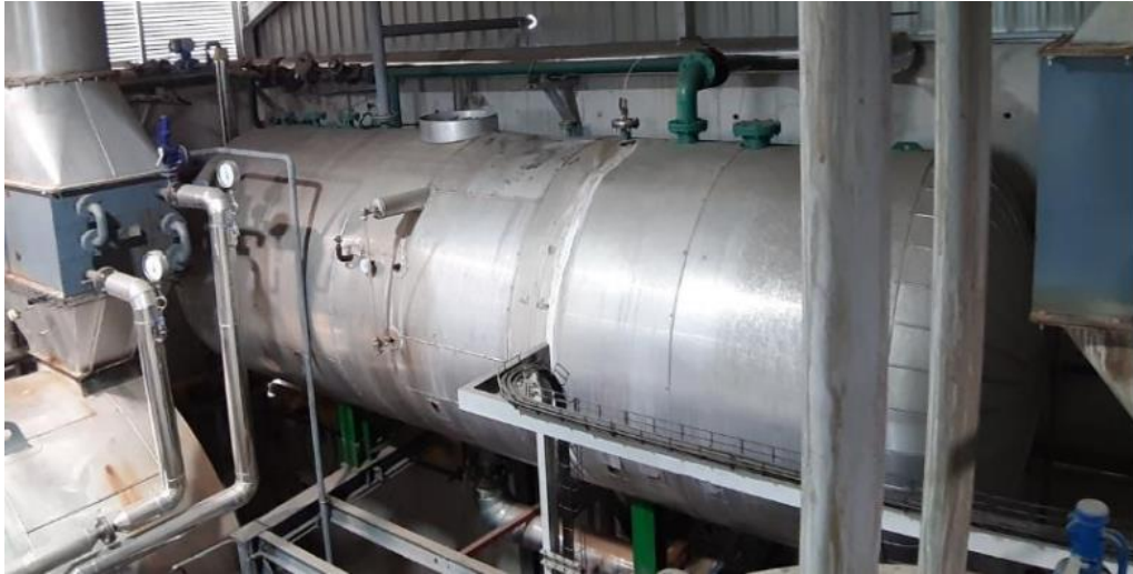
Figura 28. Depósito agua almacenamiento a calderas (18 m 3 ).
