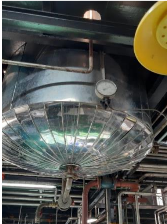
Figura 76. Depósito agua para lavado aceite semillas (90°C)
