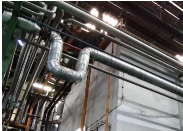
Figura 72. Dilatador mal instalado
