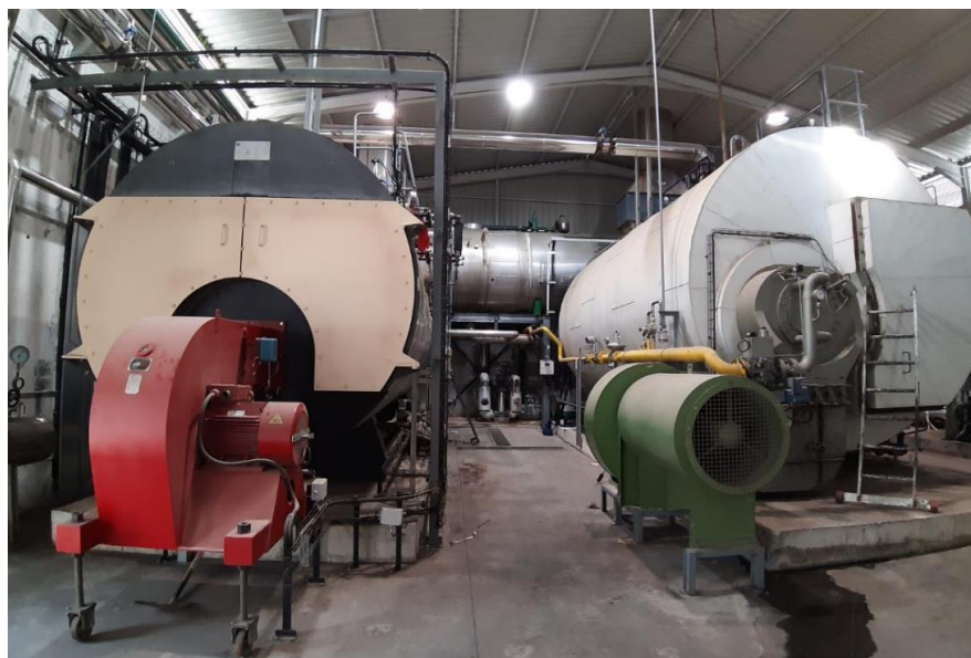
Figura 23. Calderas de vapor Migasa
