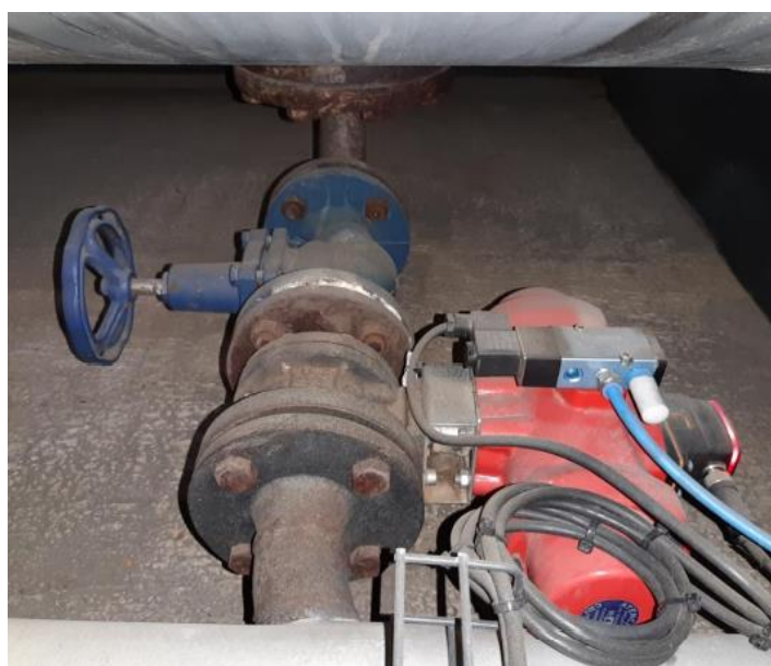
Figura 41. Purga de fondos caldera Sogecal
