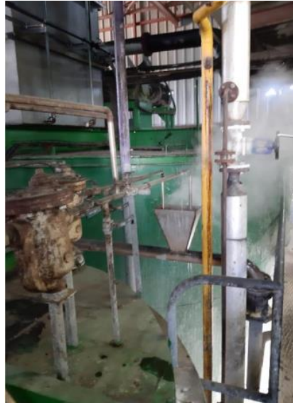
Figura 79. Condensados de calderas
