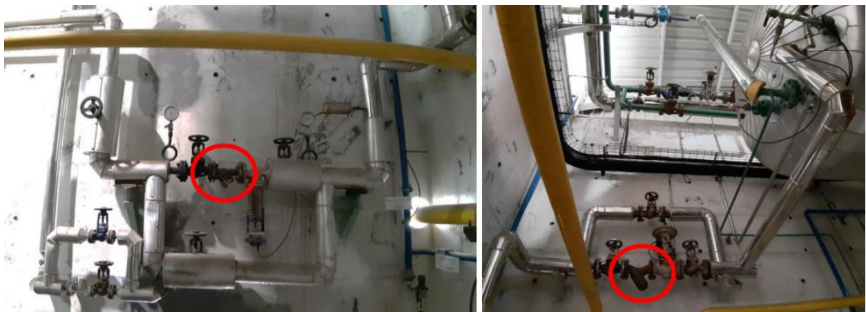
Figura 65. Filtros lanza de vapor tanque alimentación agua a calderas
