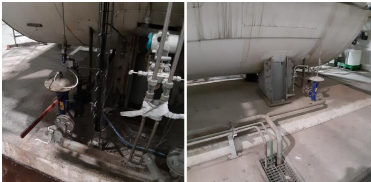
Figura 40. Purga de fondos caldera Umisa
