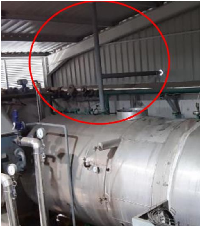
Figura 66. Tubería de rebose y venteo tanque alimentación agua a caderas
