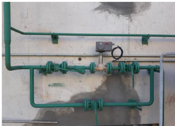
Figura 67 . Aporte agua fría al tanque de purga de fondo
