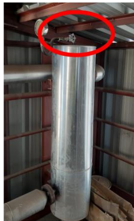
Termocompresores Física Planta superior
