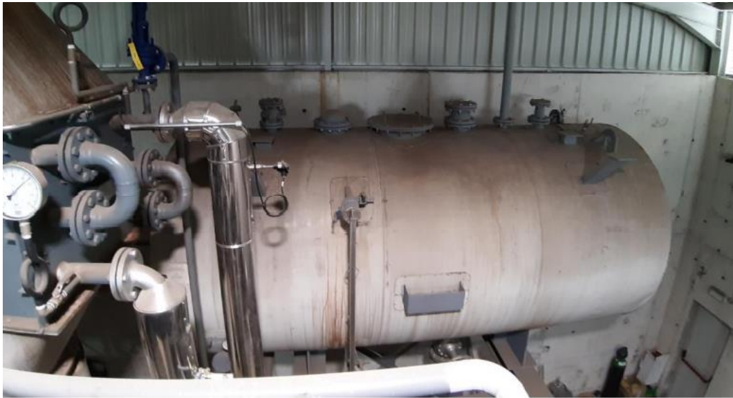
Figura 29. Depósito agua almacenamiento a calderas (12 m 3 ).
