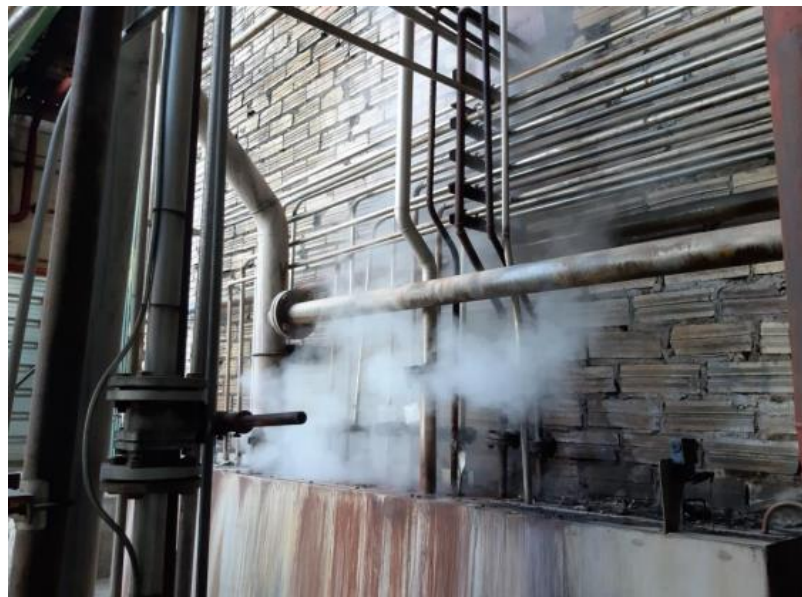
Figura 77. Caja acumulación de condensados zona “física”
