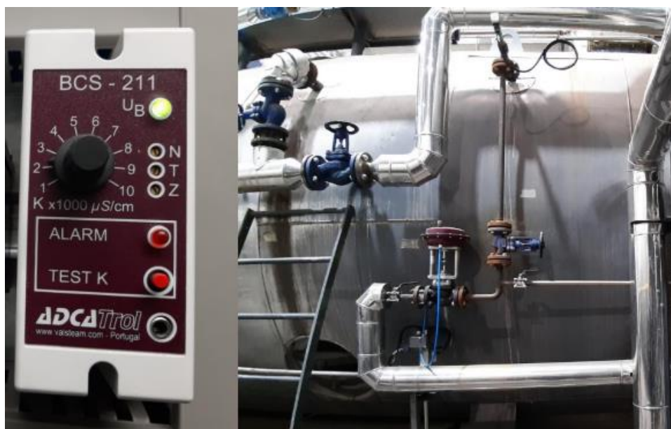
Figura 45. Purga de sales caldera Sogecal
