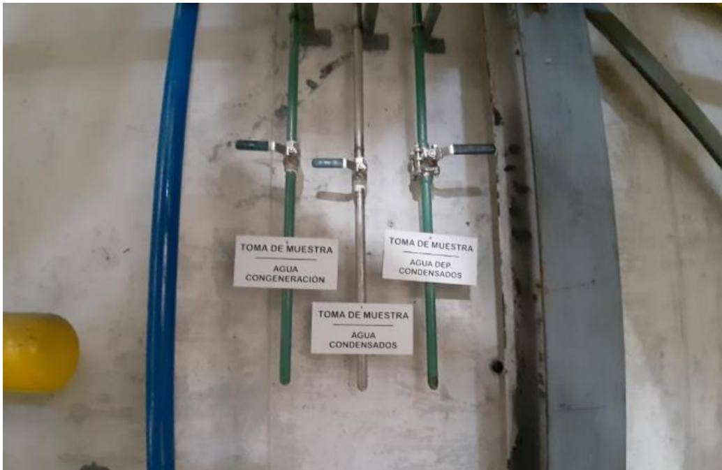
Figura 34. Tomas de muestras fluidos de alimentación al tanque de almacenamiento (Migasa).
