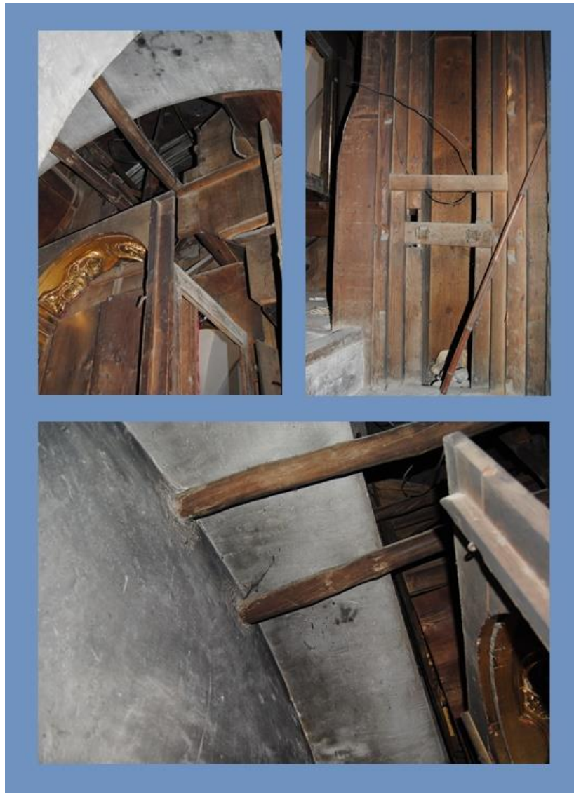
Fig. 12: superior izquierda : Estructura interna del ático del retablo. Superior derecha : Detalle estructura. Inferior : Arco semicircular original y anclajes (Fotos: Gonzalo Borrego)
