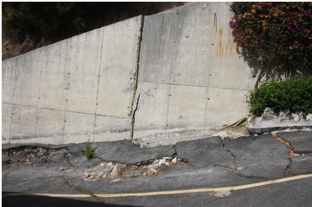
Ilustración 36. Daños y asentamientos en vial de acceso de la Urbanización Cármenes del Mar, Almuñécar, Zona de actuación.
