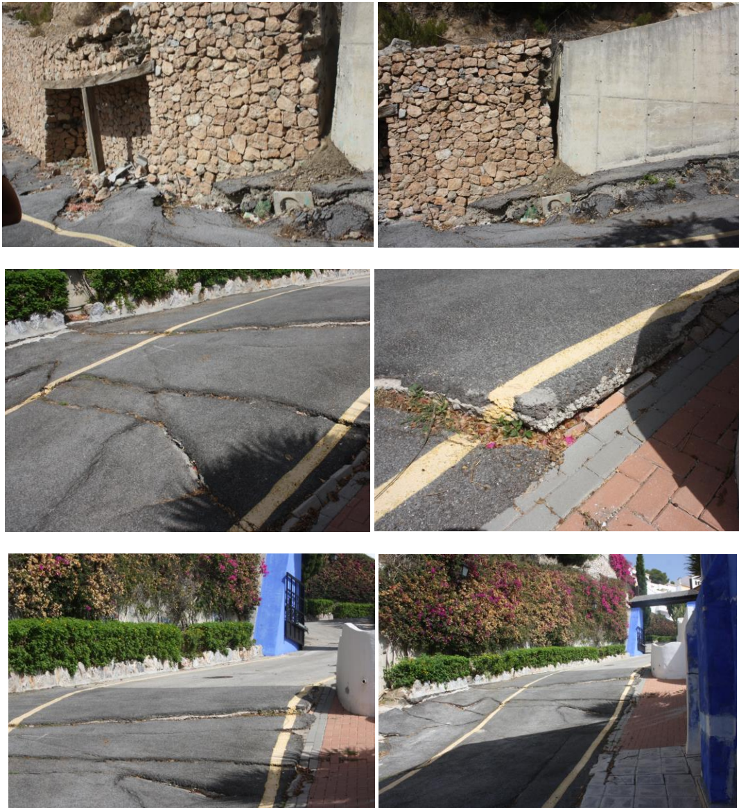
Ilustración 37. Asentamientos puntuales en vial de acceso de la Urbanización Cármes del Mar, Almuñécar. Zona de actuación.
