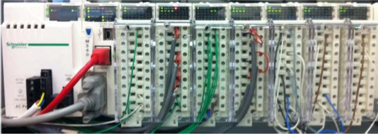
Figura 13. PLC M340 instalado en la microrred. [20]
