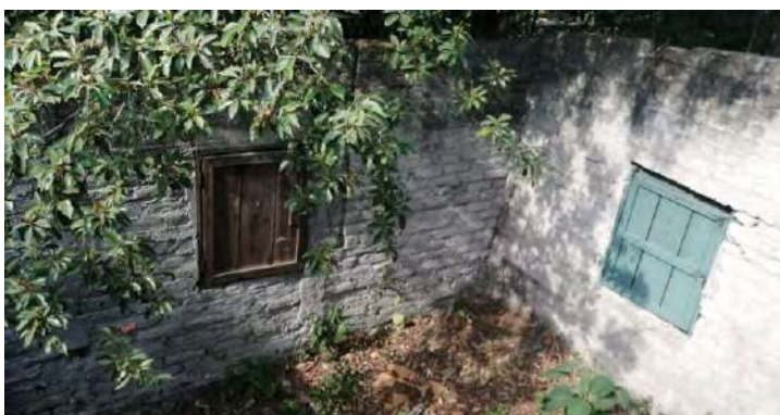
Figura 31: Casa deshabitada por deslave, Comunidad El Palmar, Ciudad Delgado Marzo 2019 Elaboración propia
