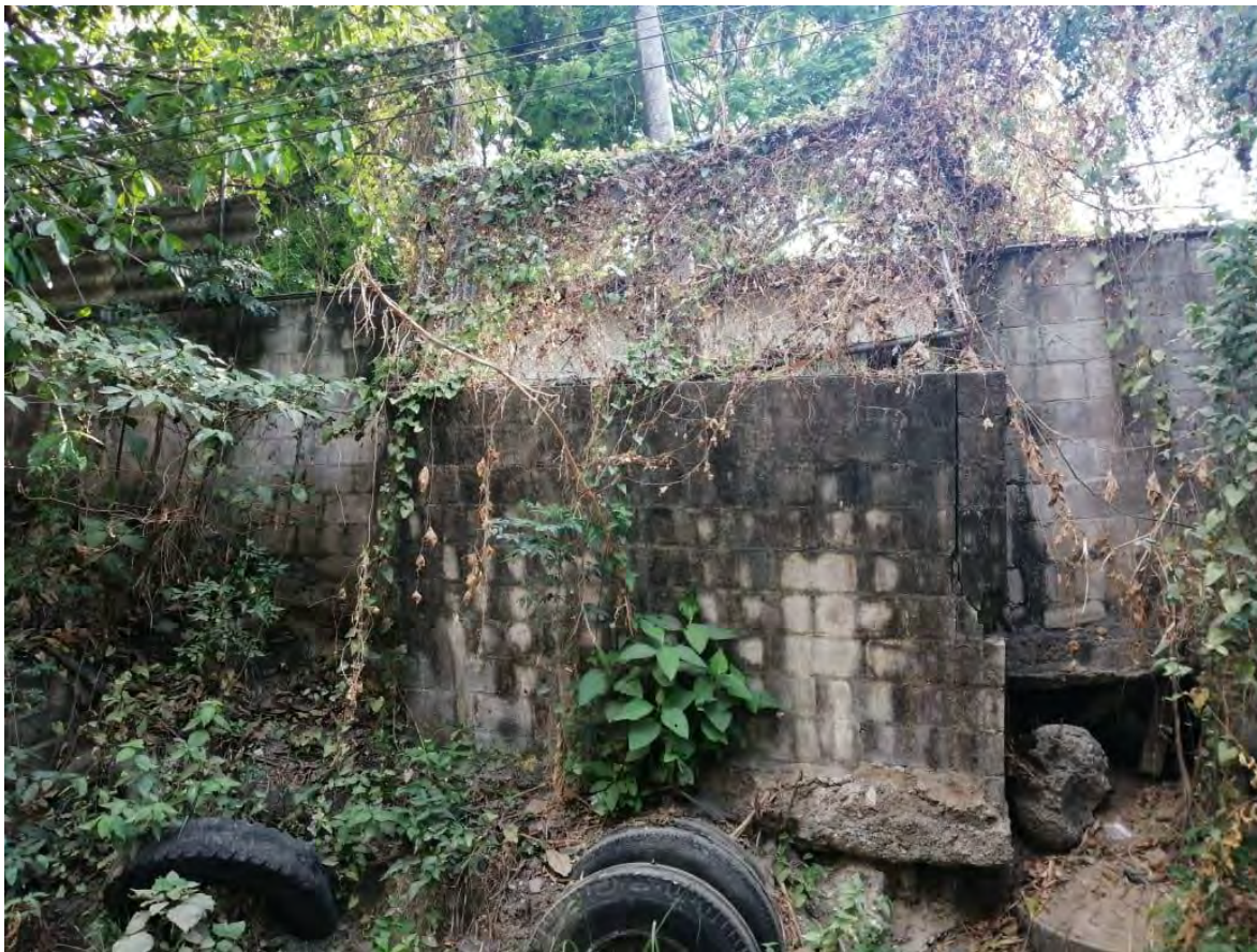
Figura 30: Desplome de muro perimetral, escuela "Refugio Sifontes", Ciudad Delgado Marzo 2019 Elaboración propia
