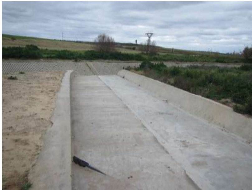
Foto 40. Ídem foto 39 con drenaje lateral de escaso calado y construido con hormigón (Estación de muestreo nº 67).
