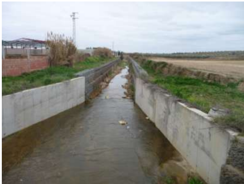
Foto 38. Última ampliación del canal artificial del arroyo Calancha en el tramo urbano de Rociana del Condado en el que se muestra en primer plano un muro de hormigón, para reducir la sección del canal, que continúa aguas abajo reforzado con muro de gaviones a tres alturas (Estación de muestro nº 60).
