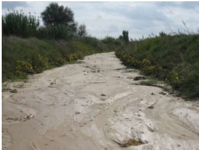
Foto 26. Tramo colmatado del arroyo Colmenar y peraltado artificial de orillas para evitar la inundación de los campos de cultivos aledaños (Estación de muestreo nº 65).
