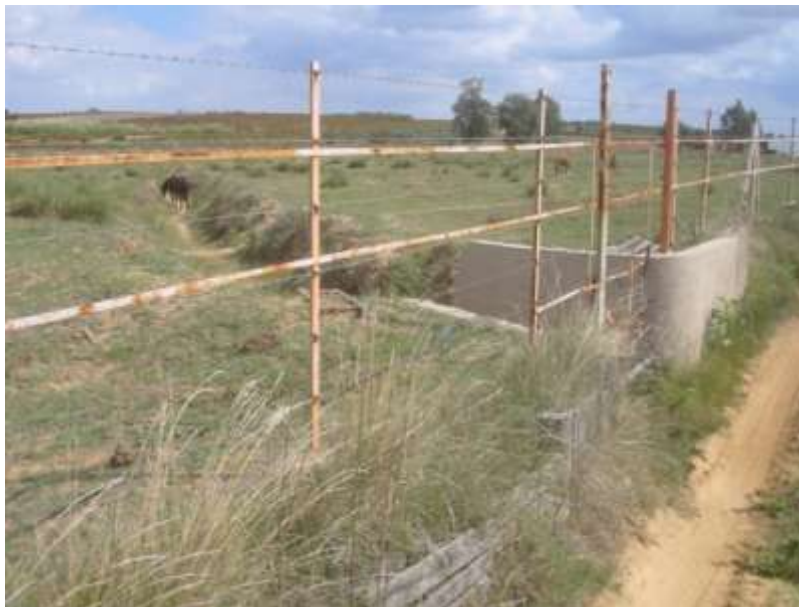
Foto 11. Canalizaciones artificiales con estructura de obra para el favorecer drenaje y desecación de parcelas ganaderas que son atravesadas por el arroyo de La Cárcava en su cabecera (Estación de muestreo nº 48).
