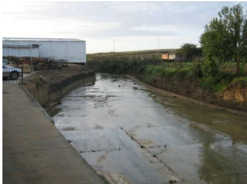
Foto 36. Canalización artificial del arroyo Calancha en el núcleo urbano de Rociana del Condado con presencia de construcciones hasta el borde la propia canalización (Estación de muestro nº 60).
