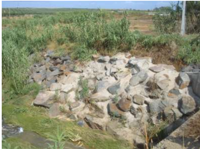
Foto 43. Protección de escolleras aguas abajo del paso de aguas del arroyo de La Cárcava en la Autovía A-483 (Estación de muestreo nº 11).
