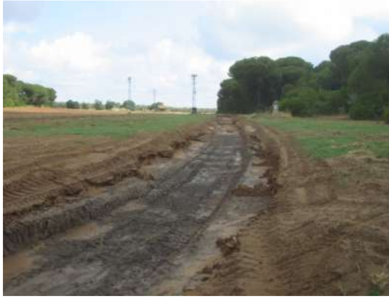
Foto 96. Rectificación y limpieza abusiva de un tramo del canal del arroyo de La Parrilla llevado a cabo por un particular (Estación de muestreo nº 35).
