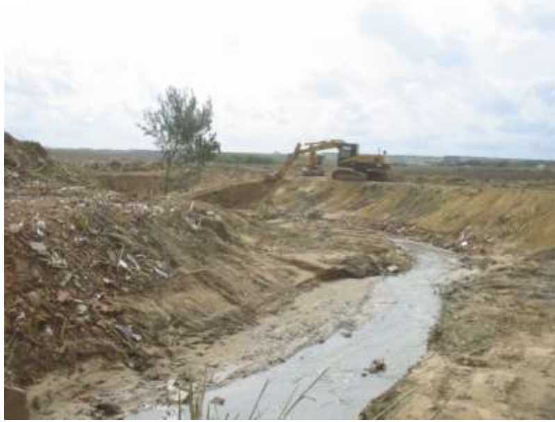
Foto 41. Remodelación artificial de la morfología del canal del arroyo de La Cerrada con maquinaria pesada y diseño de orillas con taludes a 45° desarrollados sobre material de relleno (escombros) (Estación de muestreo nº 67).
