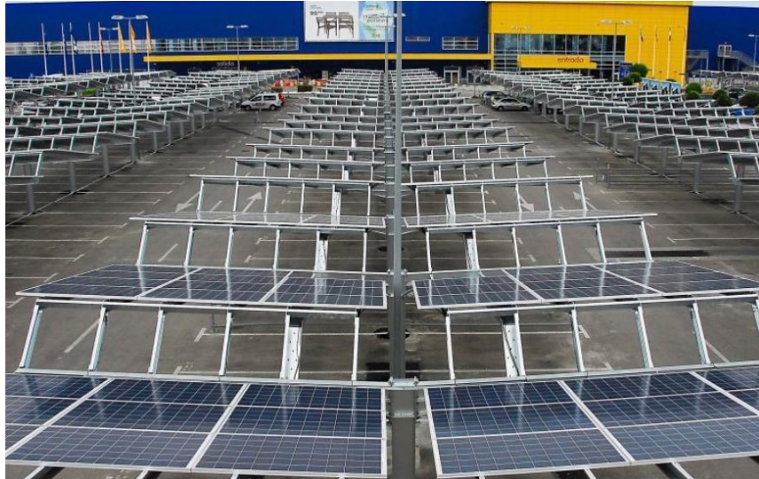
Figura 23. Ejemplo de estructura utilizada para soporte de módulos en la zona de los aparcamientos 2.
