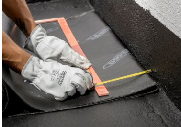
Imagen 41: medición de lámina. Fuente: leroy merlin.
