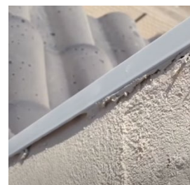
Imagen 81: guardavivos en esquina de edificio. Fuente: TRUCCSA.
