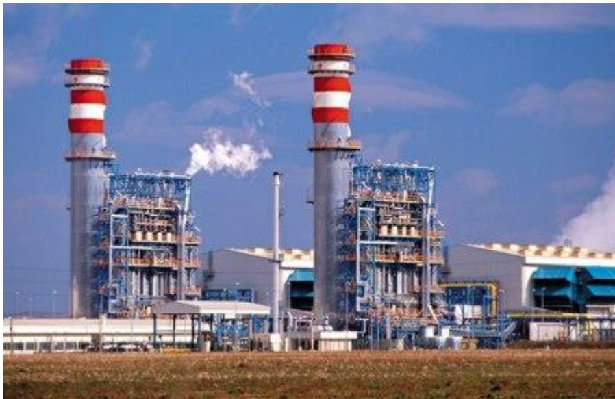
Figura 16. Planta de ciclo combinado Mérida Power 31
