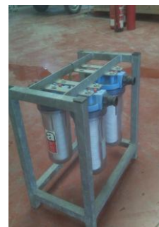
Figura 38: Equipo de filtrado
