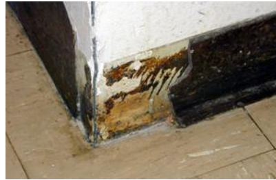
Fig. 16: Rodapié vinílico adherido con pegamento con amianto
