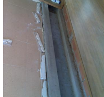
Fig. 18: Rodapiés adheridos con mortero con amianto
