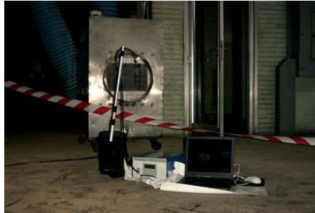
Figura 54: Realización de muestreo ambiental estático, mediante bomba de muestreo, filtro cassette y trípode en el exterior de la burbuja
