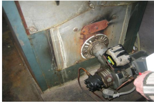
Fig. 24: Junta de caldera
