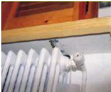
Fig. 12: Aislamiento sobre radiador
