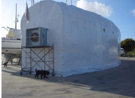
Figura 56: Ejemplo de realización de burbuja en exterior con polietileno termoretráctil en zona portuaria
