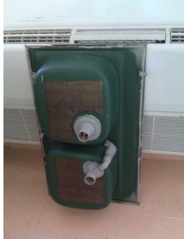
Fig. 17: Lavabo con refuerzo de amianto en su base
