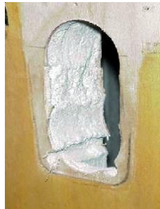
Fig. 7: Aislante en puerta cortafuego
