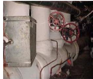
Fig. 26: Recubrimiento completo de caldera
