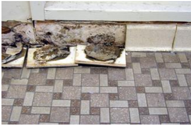
Fig. 15: Piezas cerámicas sobre pegamento con amianto
