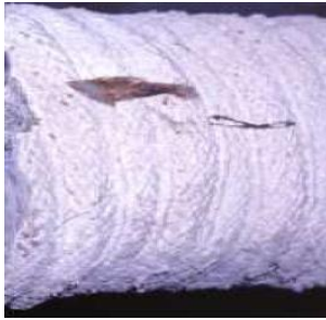
Fig. 10: Calorifugado de tubería
