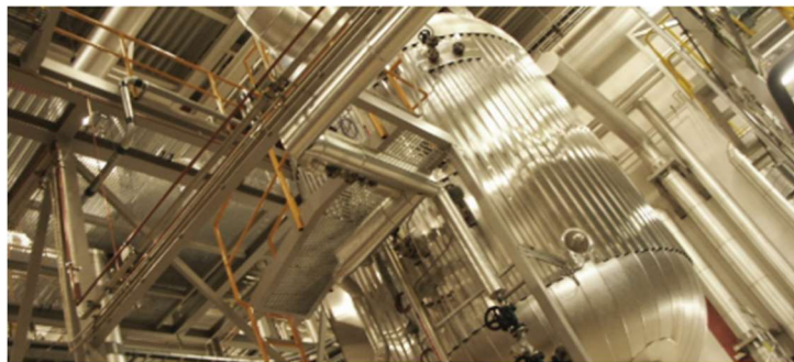
Figura 4-6 Caldera ELPANNETEKNIK de electrodos sumergidos [Fuente: ELPANNETEKNIK]
