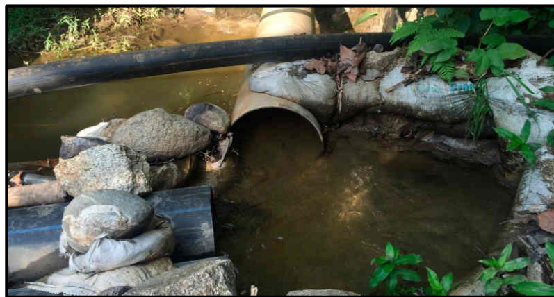
Figura 9. Infraestructura del alcantarillado de Santa Marta [10].
