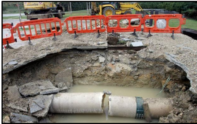
Figura 11. Fuga producida en La Maruca (Santander) que dejó a cientos de vecinos sin suministro de agua en 2019 [17].
