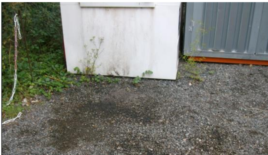
Figura 16. Manchas detectadas en el depósito de combustible
