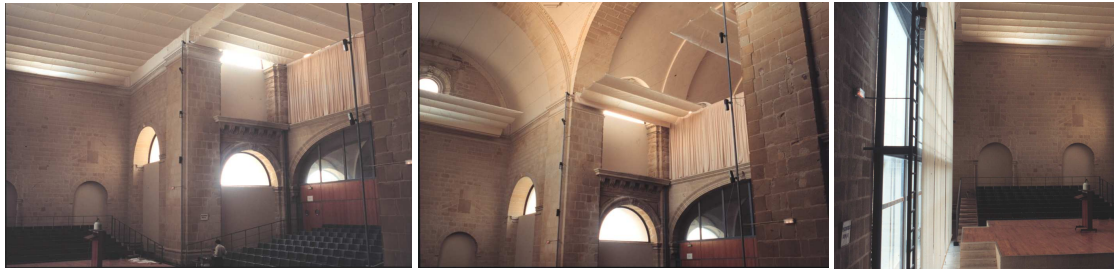
Figura 19. Vista interior tras la rehabilitación acústica. A la izquierda, los toldos extendidos y las butacas instaladas, en el centro los toldos recogidos; y, en ambas, se aprecia el textil vertical que segrega el coro. A la derecha se puede ver el textil que cubre el muro cortina.
