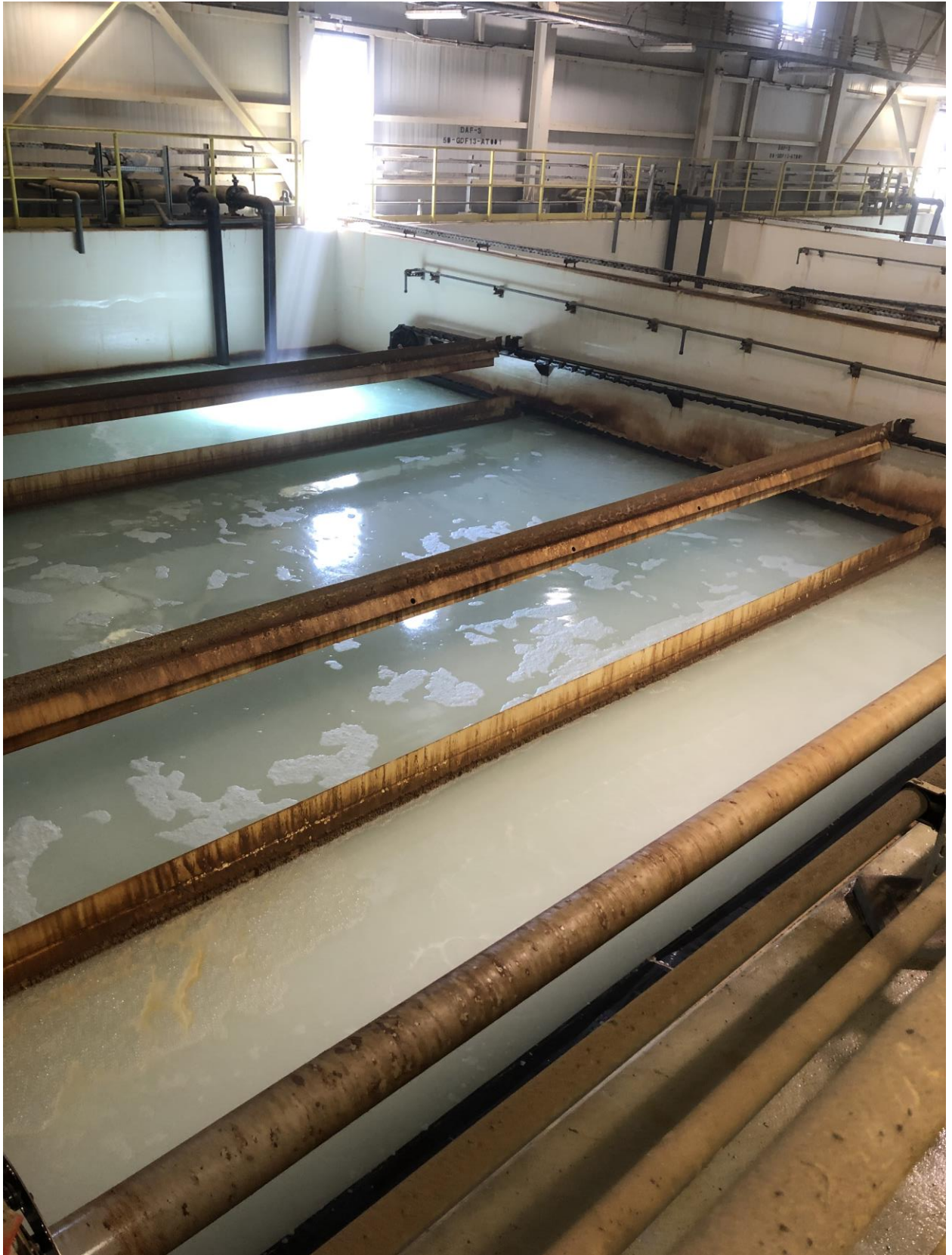
Figura 19 Superficie de una celda DAF, (Instantánea de planta)
