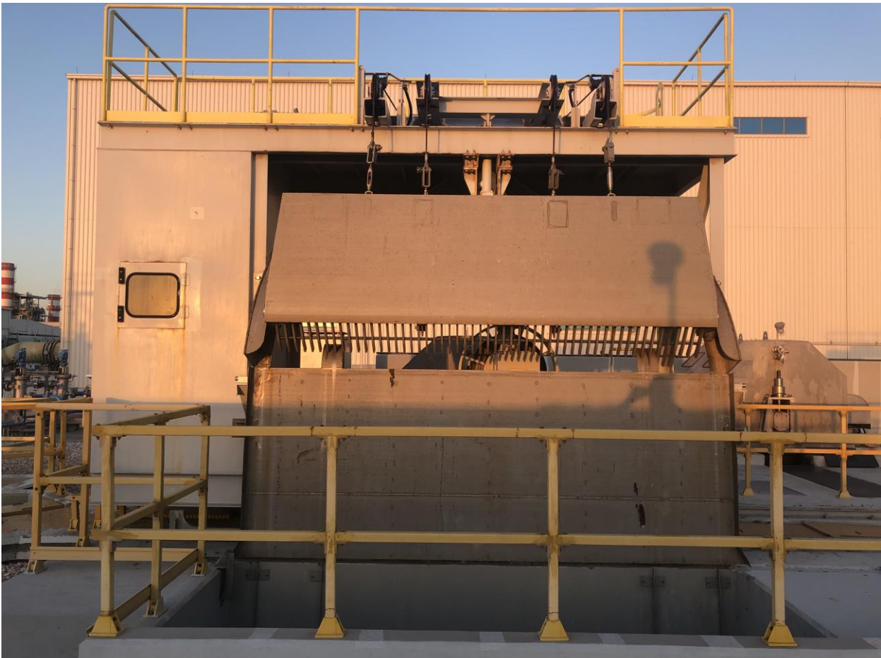
Figura 11 Bar screen con grúa, (Instantánea de planta)
