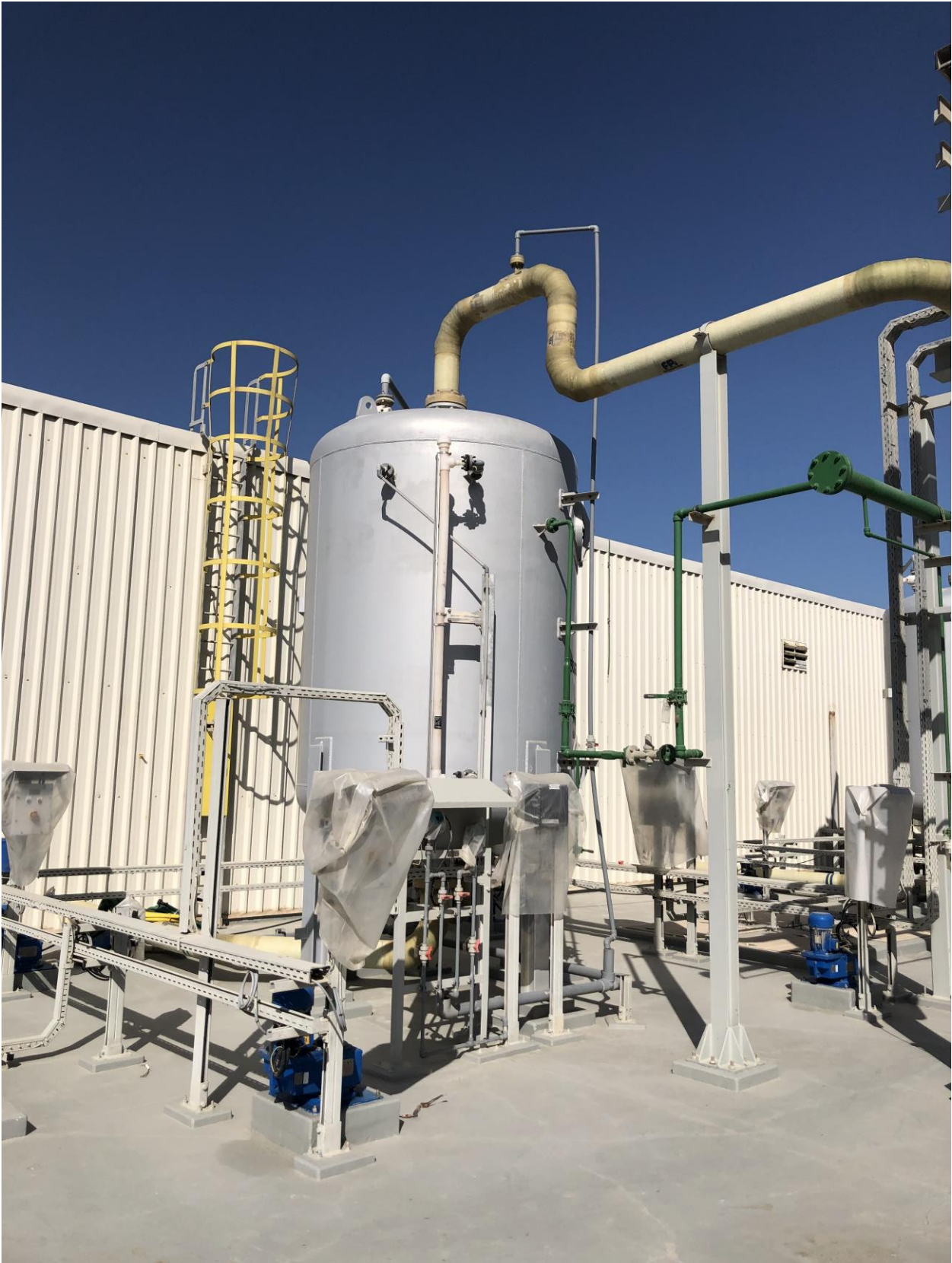
Figura 18 Tanque de saturación de los DAF, (Instantánea de planta)
