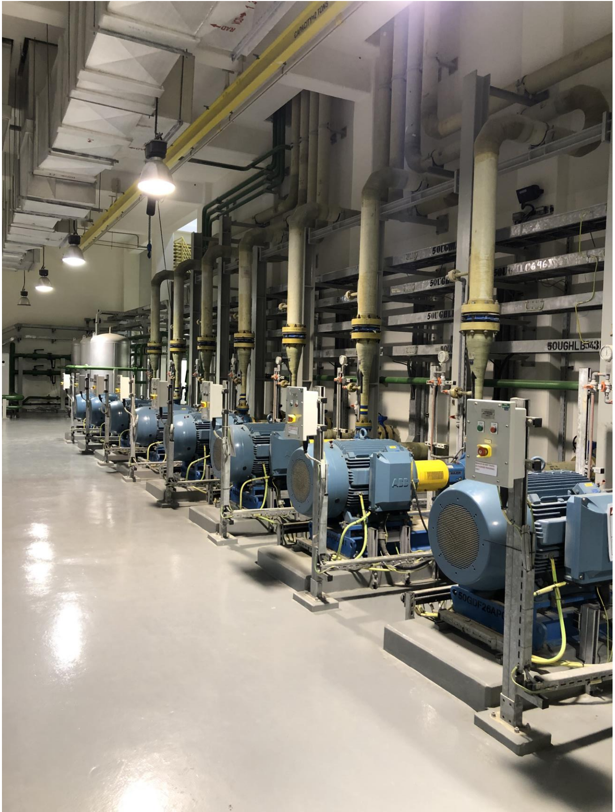
Figura 17 Bombas de recirculación de los DAF, (Instantánea de planta)
