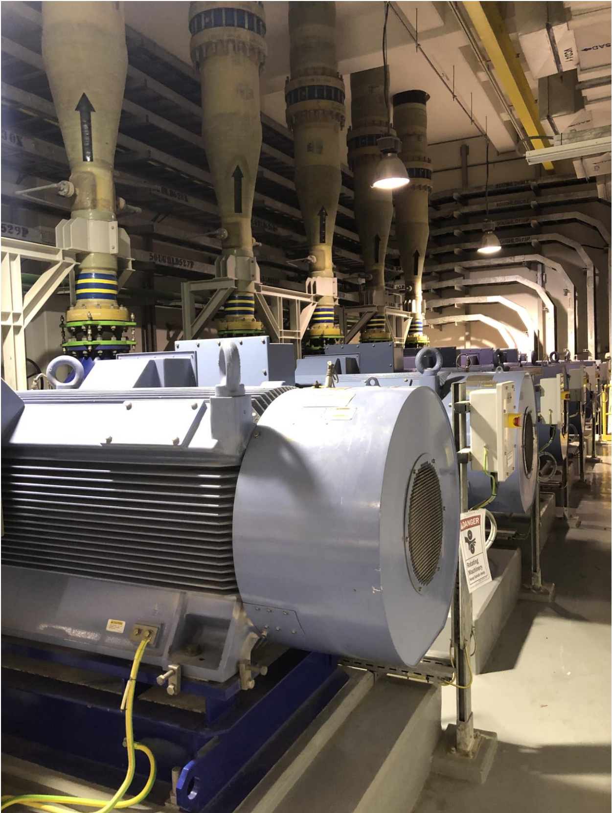
Figura 21 Bombas intermedias, (Instantánea de planta)
