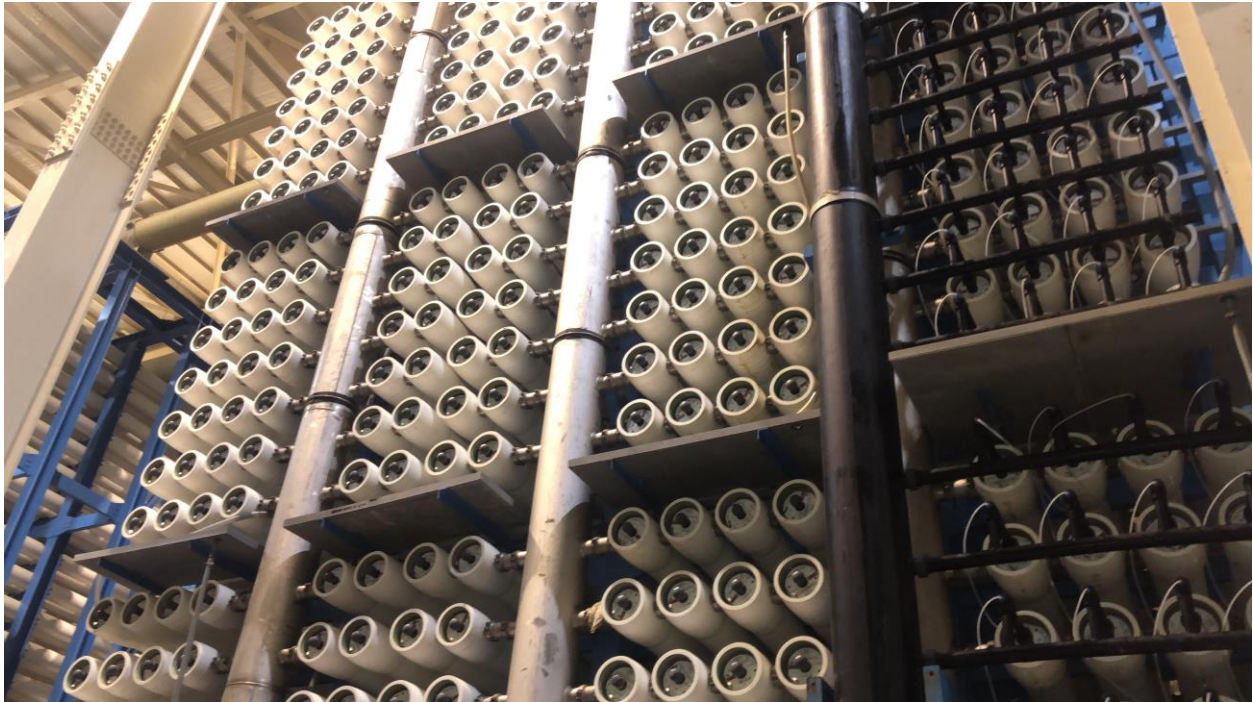
Figura 37 Bastidor de tubos de ósmosis inversa, (Instantánea de planta)
