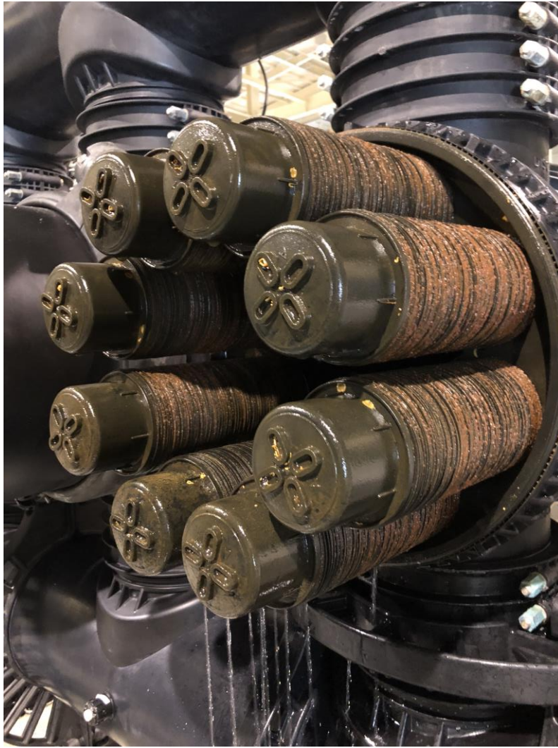
Figura 25 Espinas con restos de "biofouling" y hierro, (Instantánea de planta)
