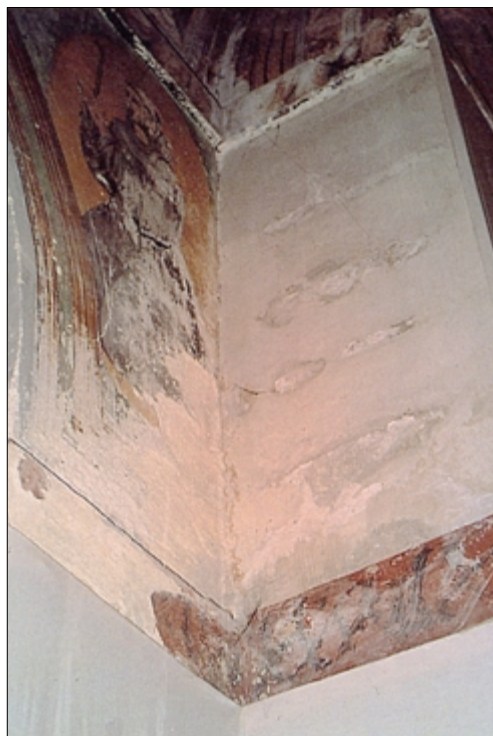
7. Filtraciones por capilaridad y eflorescencias salinas de los paramentos de la Sacristía
