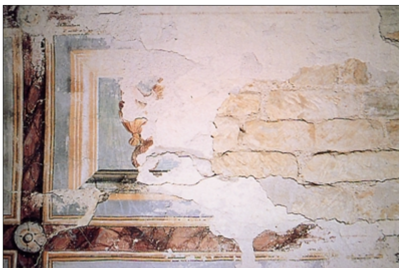
4. Pérdida de color y eflorescencias salinas de uno de los casetones de la bóveda de la Sacristía
