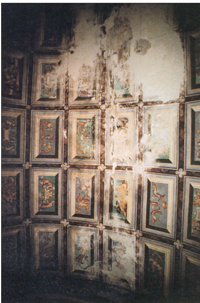
3. Deterioro de la bóveda de la Sacristía
