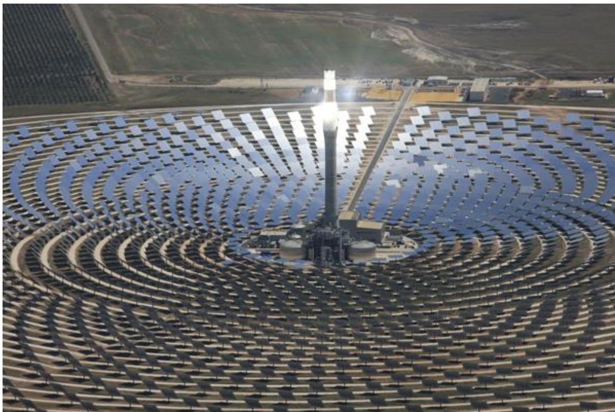
Figura 7. Planta termosolar de torre, Gemasolar (Sevilla, España) [7].
