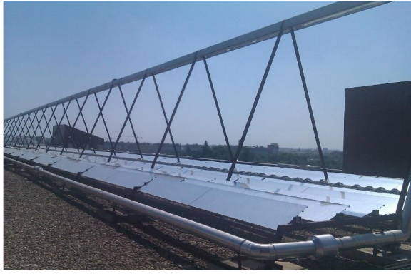
Figura 1: Campo de colectores Fresnel
