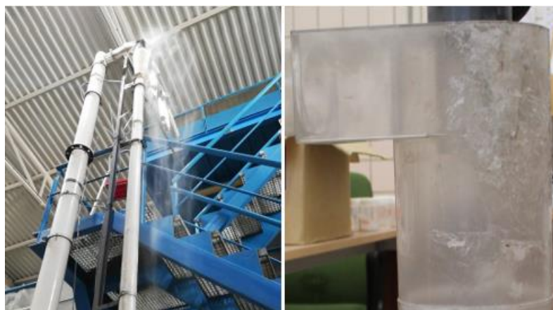
Figura 3-21. Fuga de material en la unidad (izq) y estado del ciclón tras desmontarlo de la unidad para evidenciar las roturas (dcha).
