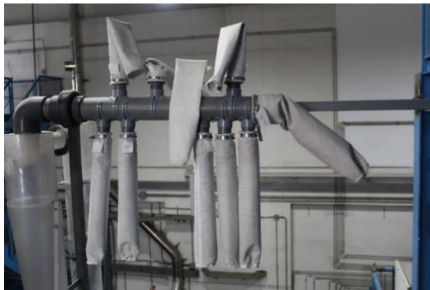
Figura 3-8. Filtros de manga instalados a la salida del ciclón.
