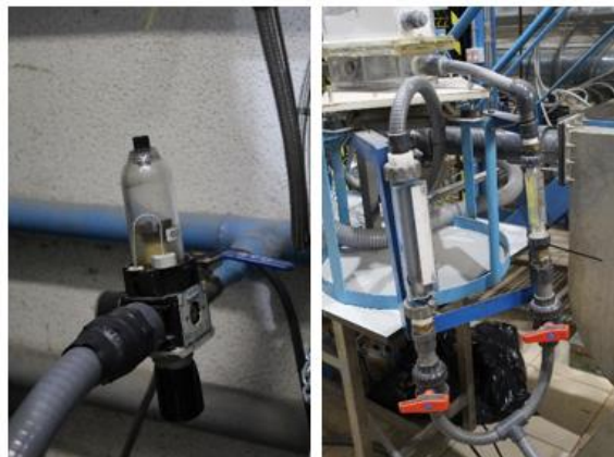
Figura 3-14. Red de aire comprimido (izquierda) con regulador de presión y filtro, y rotámetros para ajusta el caudal (derecha).
