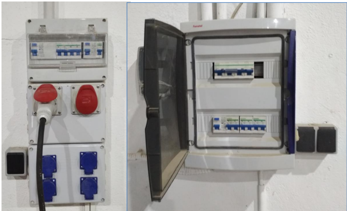
Figura 5-6. Muestra de la señalización actual en los cuadros eléctricos. Fuente: Elaboración propia.
