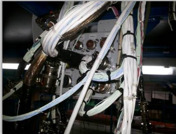
Figura 6-83. Fines de los mazos en la zona de corte de A/C.
