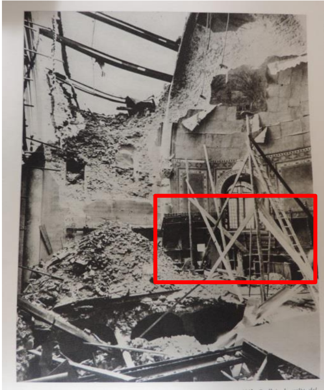
Figura 3. Detalle del bombardeo acaecido sobre el ábside de la basílica. En el rectángulo rojo se pueden observar partes del coro afectadas por la caída de la estructura arquitectónica
