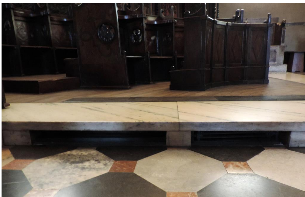
Figura 51. Pavimento con calefacción
