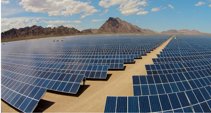
Figura 1 Parque de Paneles Solares. Fuente EcoSolarEsp.Com.
