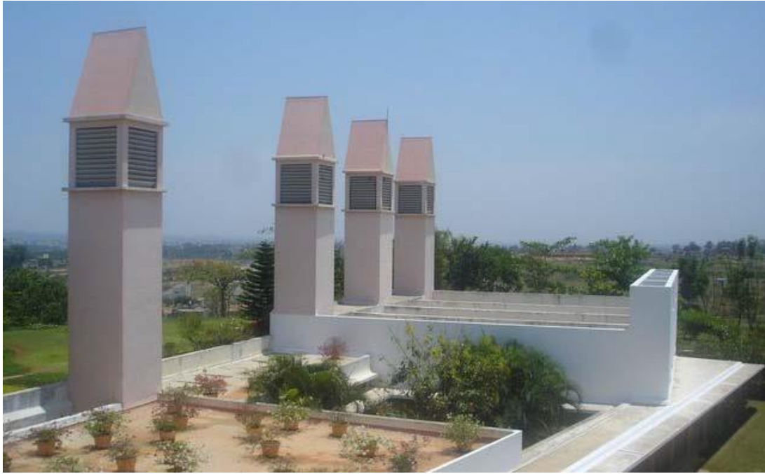
Imagen 2 Torres del sistema PDEC del edificio CII en Bangalore, India. (Ford, 2010)
