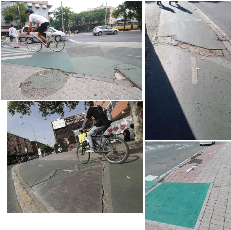
Figura 4-7. Ejemplos de deficiencias debidas a una mala planificación en Avda. Coria (superior izquierda), Isla de La Cartuja (superior e inferior derecha) y Avda. José Laguillo (inferior izquierda). Fuente: Sevilla.abc.es y fotos propias.
