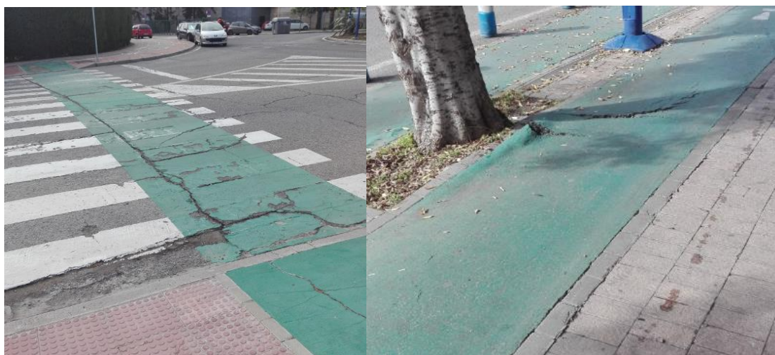
Figura 4-13. Grietas en el carril bici en la zona de Isla de la Cartuja.
