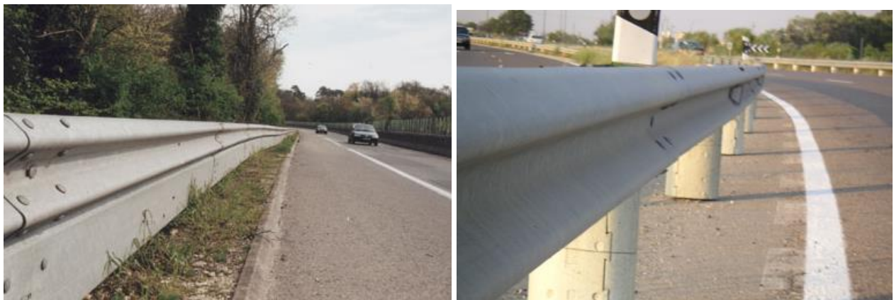
Figura 2-30. Guardarraíles modificados con barreras (izquierda) y recubriendo los postes (derecha).
