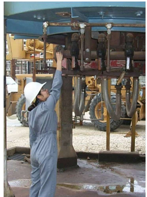
Figura 1-1. Diseño no adecuado para mano de obra local
