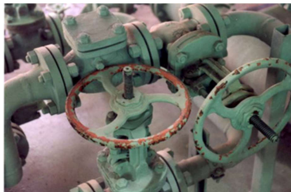
Figura 1-4. Localización incorrecta de una válvula
