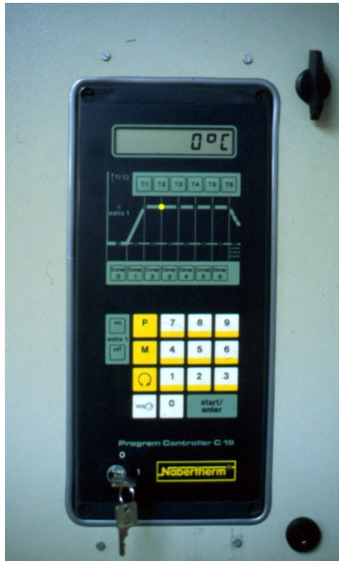
Fig. 44 – Tablero de mando digital de un horno
