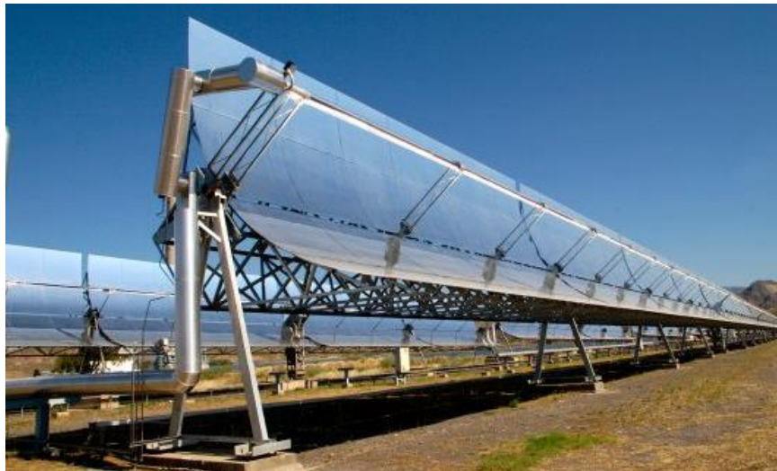
Figura 1-2. Central termosolar de colectores cilindro-parabólicos [2].
