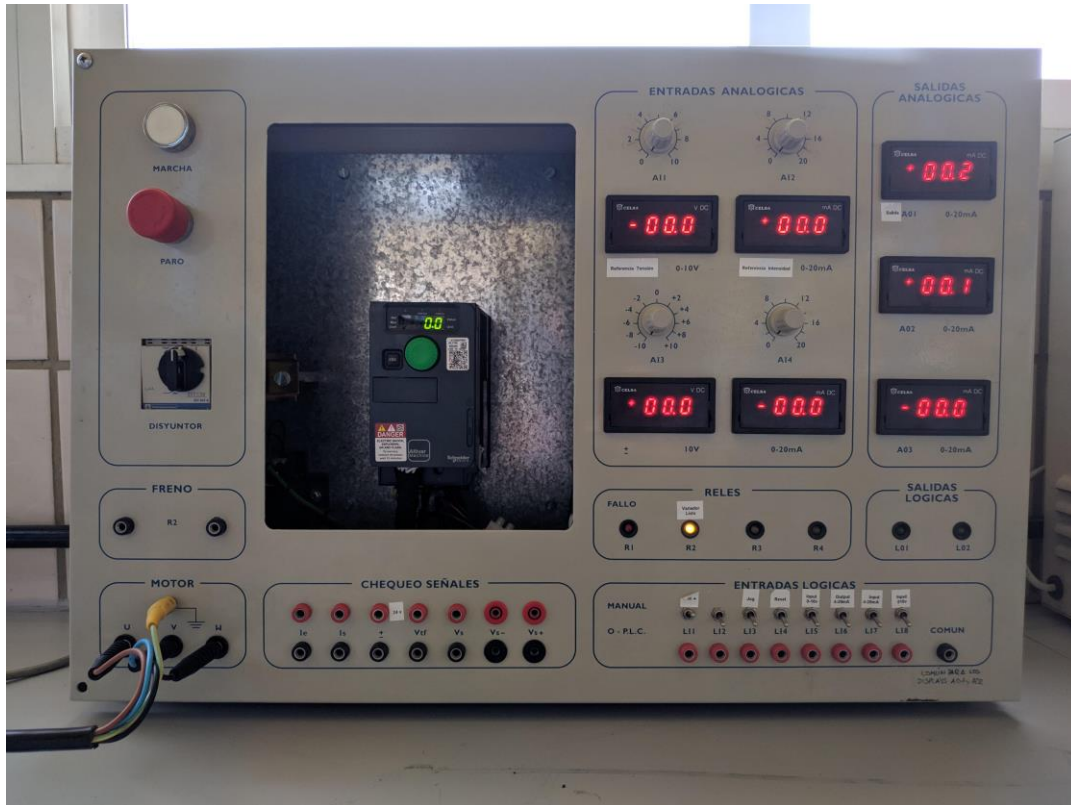
4 Vista del armario de control
