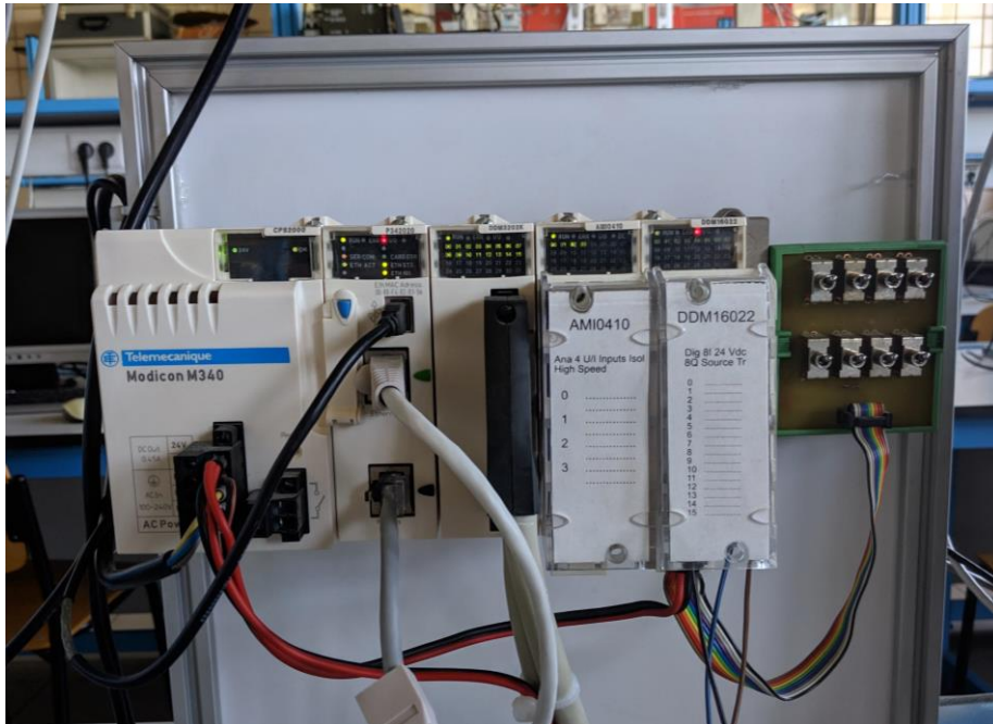
7 Vista del PLC Modicon M340 y de las tarjetas de E/S
