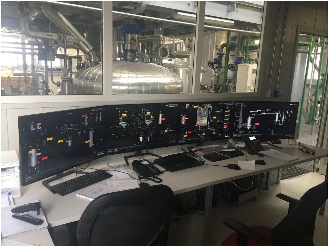
Figura 2-6: Cuadro de mandos de la refinría de Vilches de Acesur.
