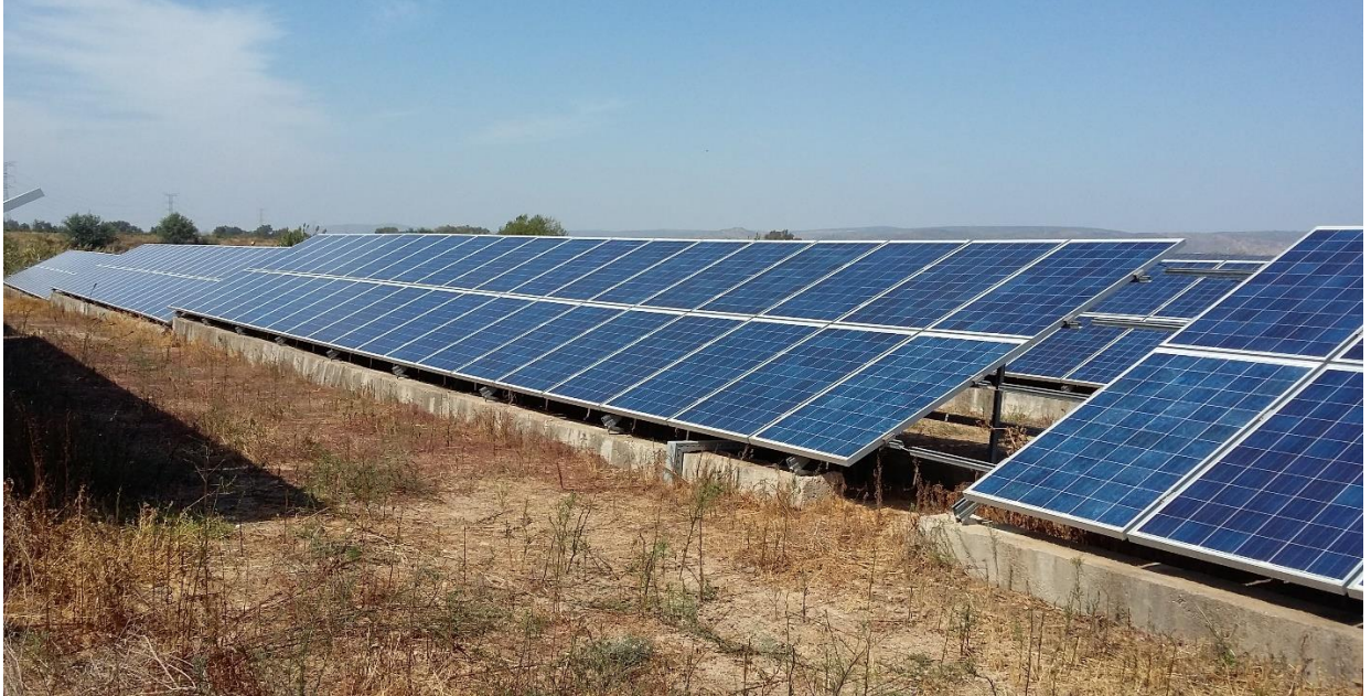
Figura 1-5. Estructura Fija EFV Cantillana
