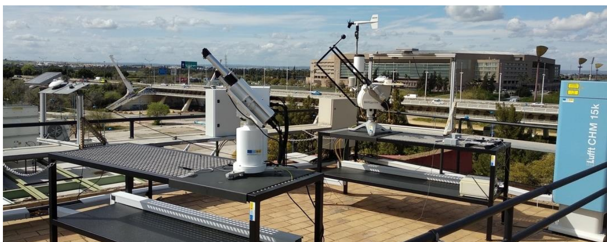
Ilustración 4-1: Estación Meteorológica del Grupo de Termodinámica y Energías Renovables de la ETSI de Sevilla. Fuente: http://estacionmeteo.us.gter.es/
