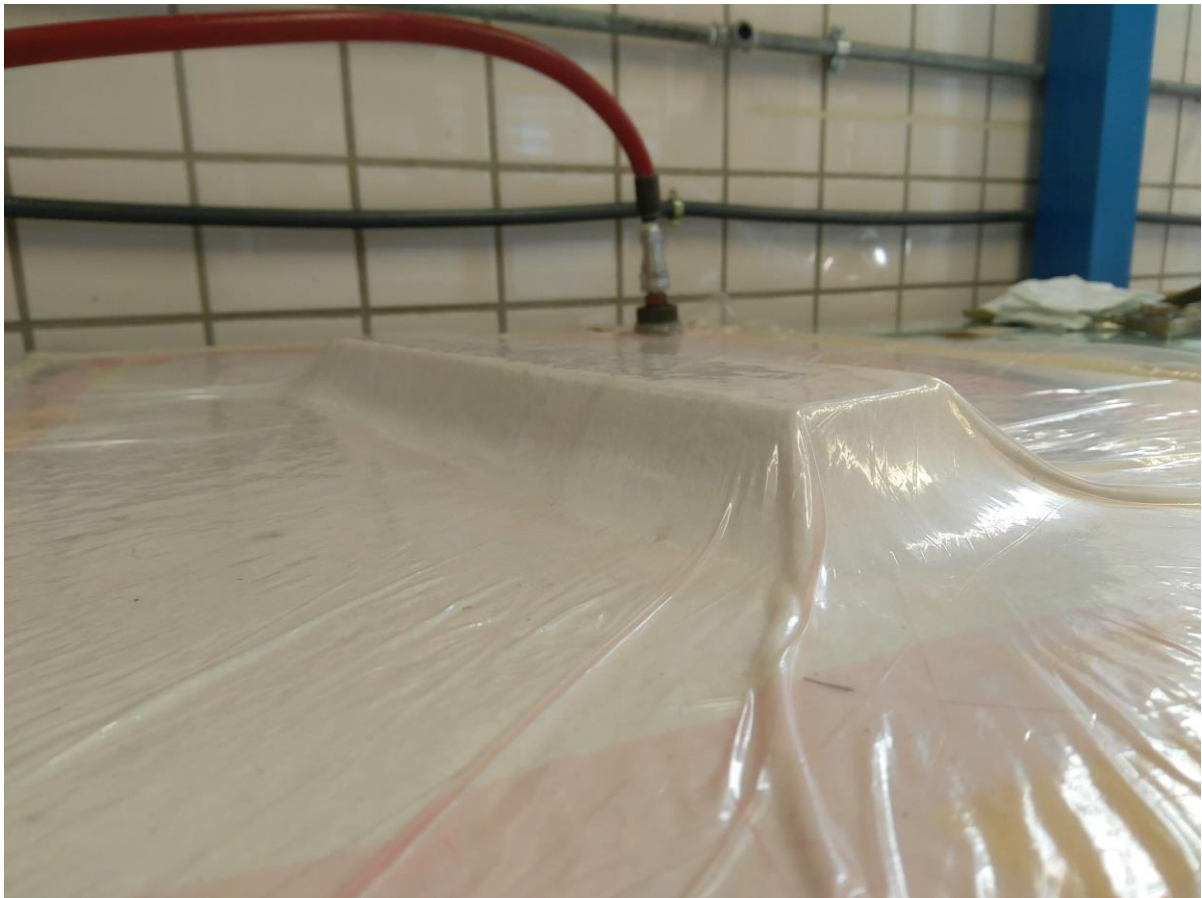
Figura 2.7. Molde y laminados metidos dentro de la bolsa de precompactación mientras succiona aire.
