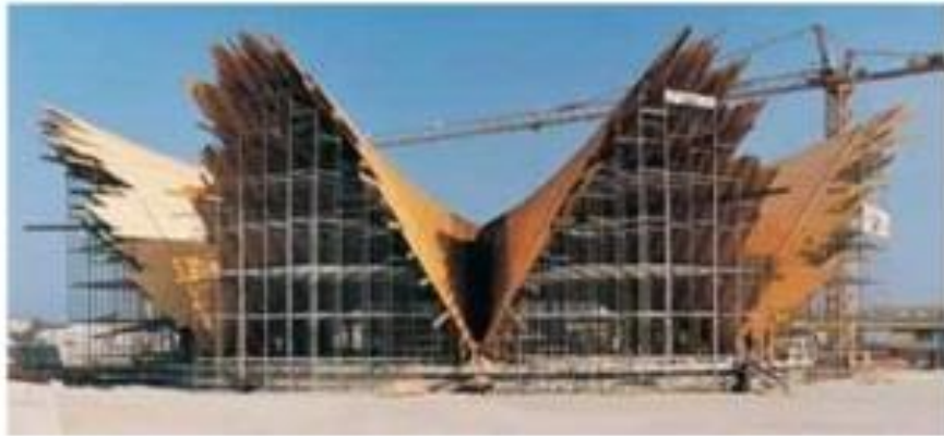
Figura 77: Cubierta del restaurante submarino de L'Oceanogràfic sito en la Ciudad de las Ciencias y las Artes. La planta del edificio es octogonal y su cubierta de hormigón presenta ocho lóbulos con simetría radial que le dan una forma de roseta. Cada lóbulo y su opuesto forman parte de un mismo paraboloides hiperbólico.
