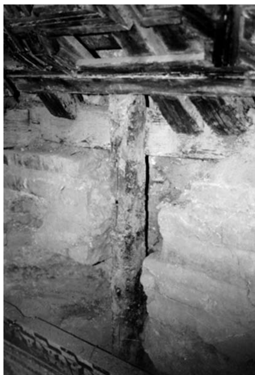
Figura 7 Semiempotramiento de estribo en paramento vertical. Se aprecia con claridad el acusado deterioro del muro de carga, del plano de asiento y del encuentro entre estribos. La inclusión de los maderos para fijación del alicer del arrocabe acentúa considerablemente los daños
