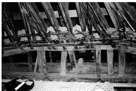
Figura 6 Apoyo de uno de los estribos de la armadura del Anteoratorio sobre puntales de madera
