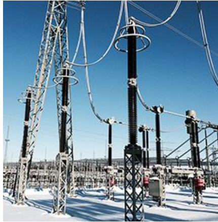
Figura 12. Autoválvulas o pararrayos.
