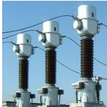
Figura 9. Transformadores de intensidad.
