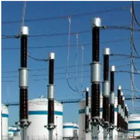
Figura 8. Transformadores de tensión.
