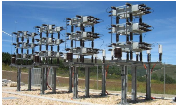
Figura 14. Baterías de condensadores.
