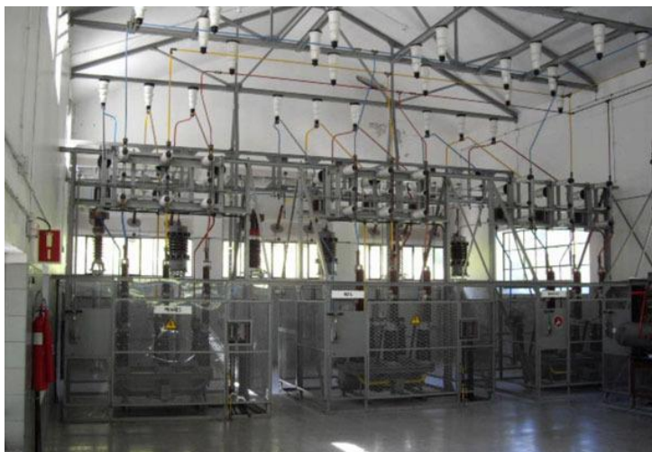
Figura 5. Subestación de interior.
