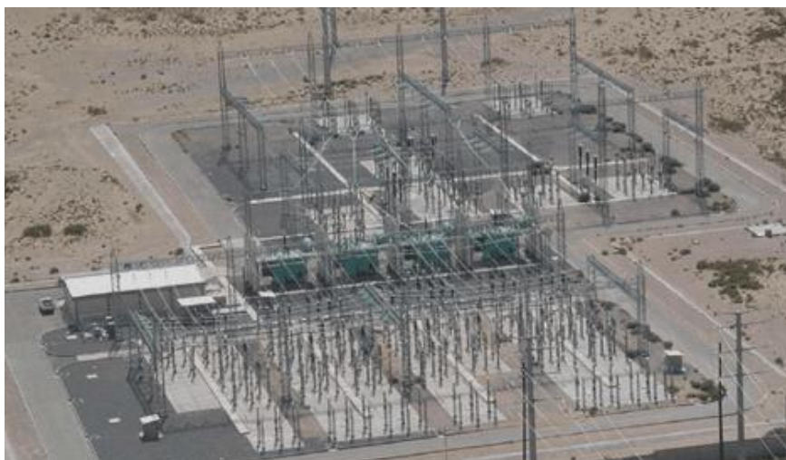
Figura 4. Subestación de intemperie.
