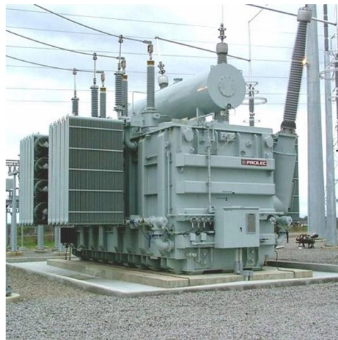
Figura 13. Transformador de potencia.
