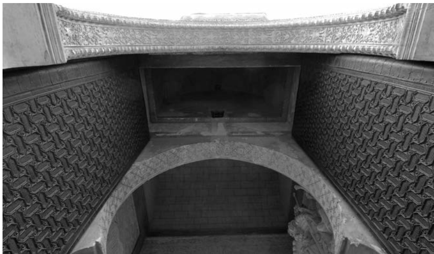
Figura 4. Vista cenital del primer tramo del zaguán, entre los arcos “I21Jn” (con decoración plateresca) en la parte superior y “I21Js”, en el centro de la imagen (con decoración almohade) y las hojas de la puerta abatidas entre los dos; bajo ellos se ve la bóveda de cañón y la parte alta del arco “I20J” (Foto del autor).
