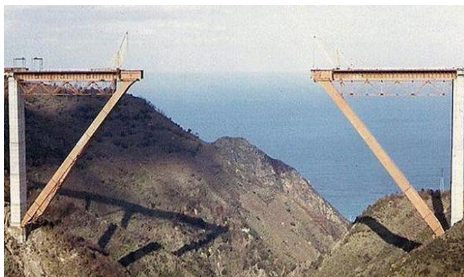
Figura 1.18 Strut Frame para una autovía en Salerno (Calabria, Italia). Salva un valle de gran dimensión
