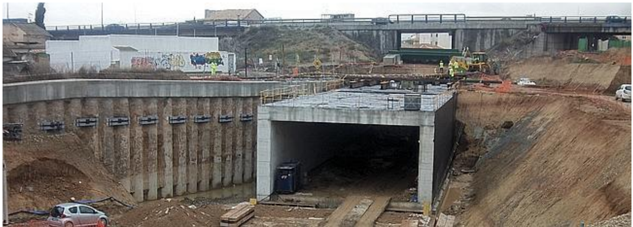
Figura 2.1 Paso inferior para ferrocarril en el que se emplea un puente pórtico
