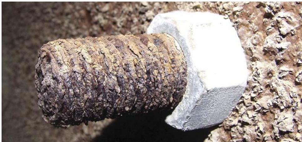
Figura 3.1. Corrosión galvánica (da.wikipedia.org).
