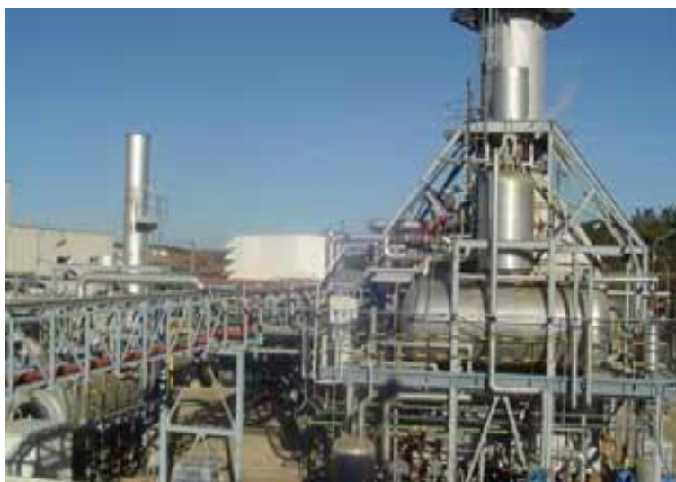
Figura 23. Planta de cogeneración
