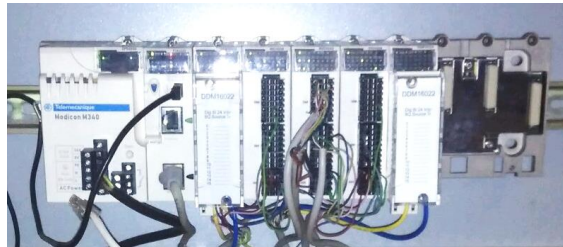
Figura 3-8. Controlador Lógico Programable instalado
