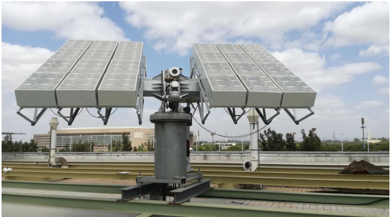
Ilustración 2 Seguidor fotovoltaico desarrollado instalada en la ETSI, Sevilla
