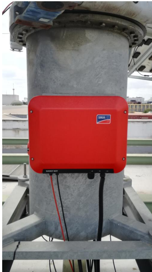
Ilustración 9 Inversor SunnyBoy instalado en seguidor
