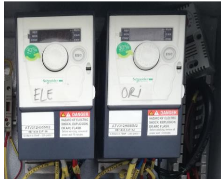
Ilustración 38 Imagen tomada de los dos variadores instalados en el seguidor
