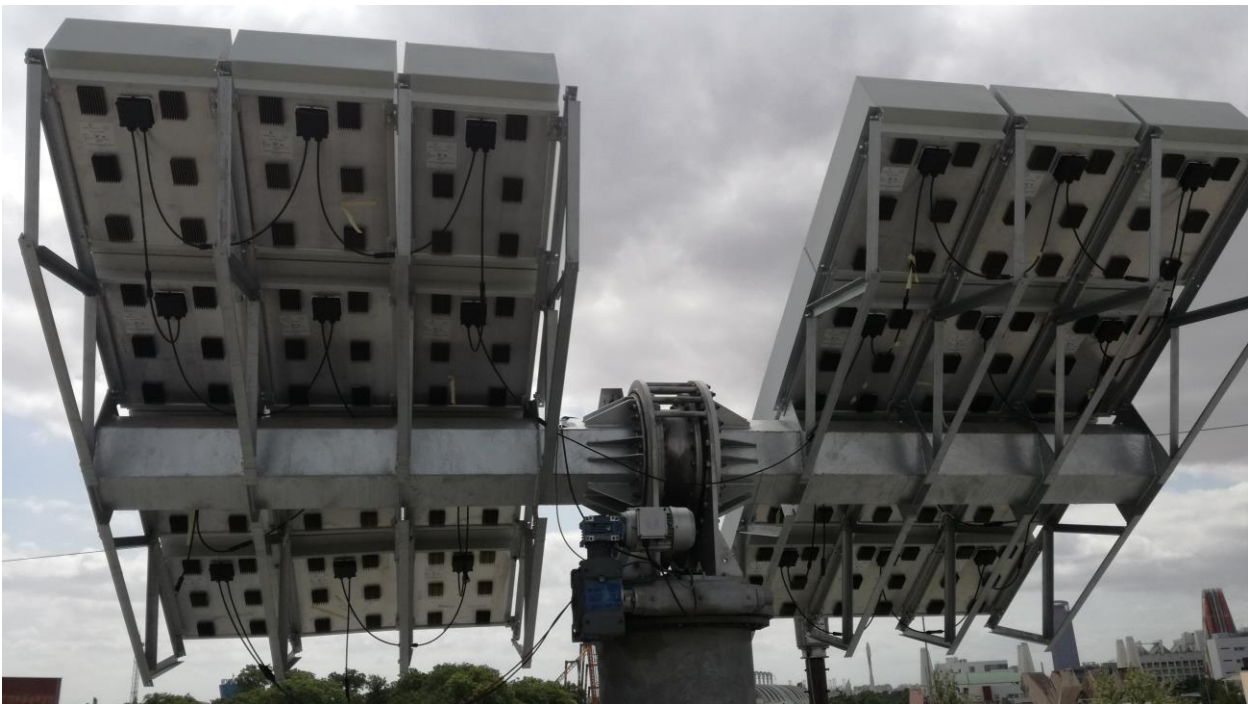
Ilustración 10 Parte inferior del seguidor Solar, se aprecia la conexión en serie de los paneles. ETSI, Sevilla
