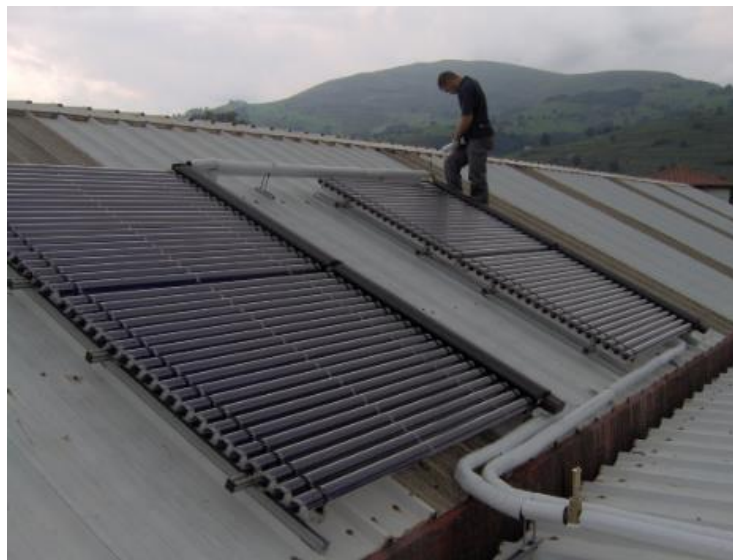
Figura 20 - Captadores de tubo de vacío [8]
