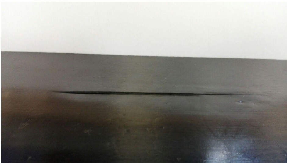
Figura 3.11 – Grieta cara posterior.
