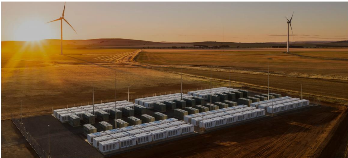
Figura A 1. Sistema de almacenamiento The Hornsdale Power.
