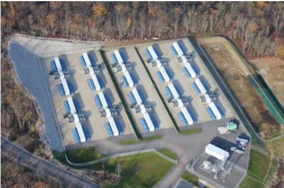
Figura 14. Planta de volantes de inercia de Stephentown, NY [45]
