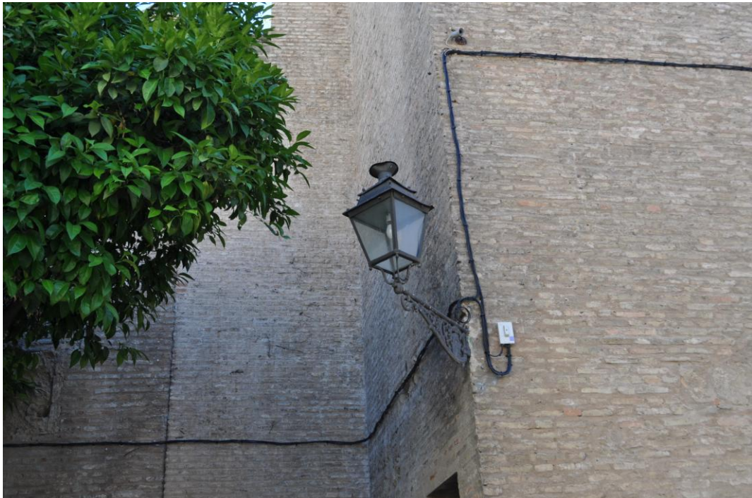
Imagen 76. Luminaria Iluminación indirecta Plaza de la Alianza.
