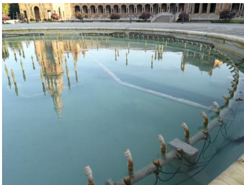
Imagen 12. Detalle de alumbrado vista general.
