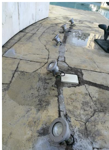
Imagen 43. Luminarias del monumento
