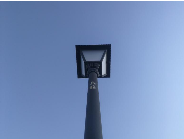
Imagen 60. Detalle iluminación indirecta LED
