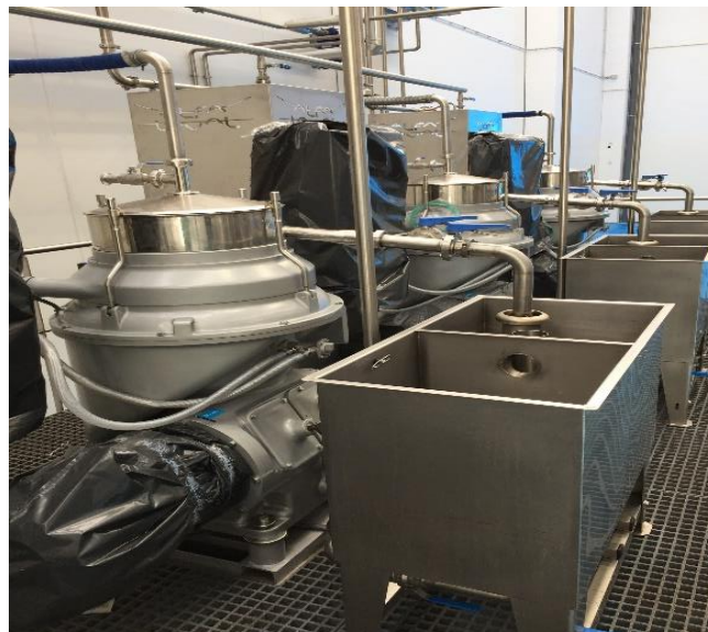
Figura 7: Separadores verticales centrífugos y cubos para la recepción de agua
