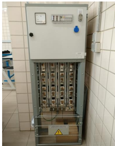
Ilustración 1.1. Cuadro distribuidor de baja tensión (CBT)
