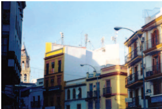
Fig. 22. Instalaciones de telefonía móvil sobre edificio de la calle Almirante Apodaca
